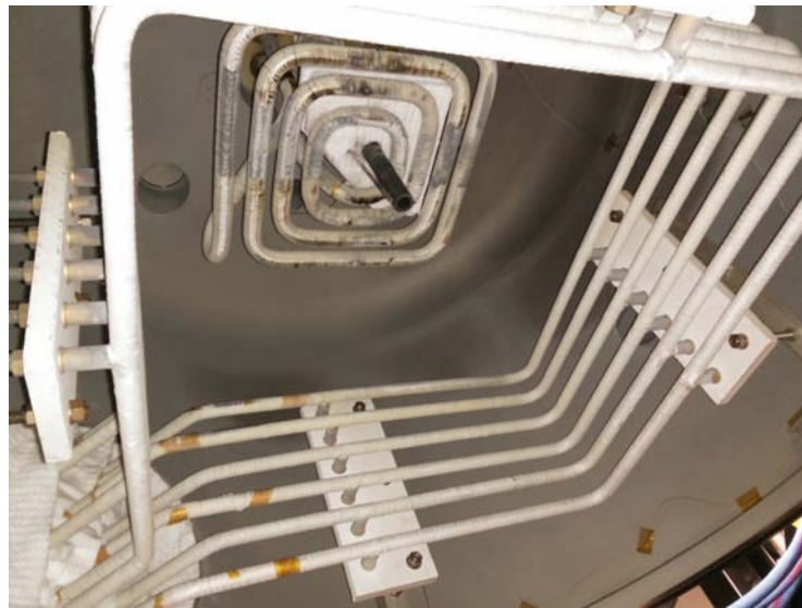
Figura 5.2: Induttori laterale e superiore installati nel forno iDSS
