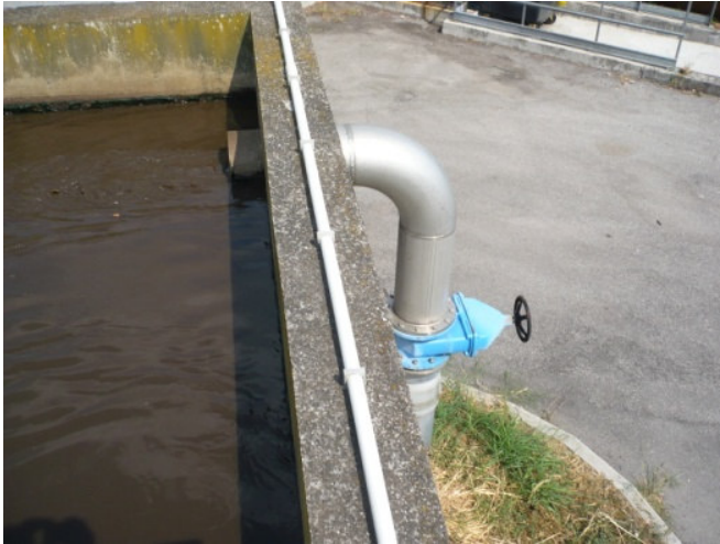
Fig. 3.2: ingresso liquame nella vasca di denitrificazione.
