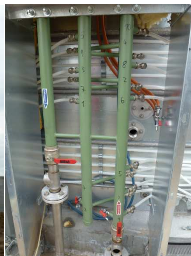
Figura 10.10 - Collettore tubazioni di riscaldamento.
