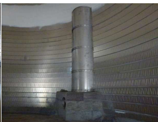
Figura 10.6 - Interno del digestore.
