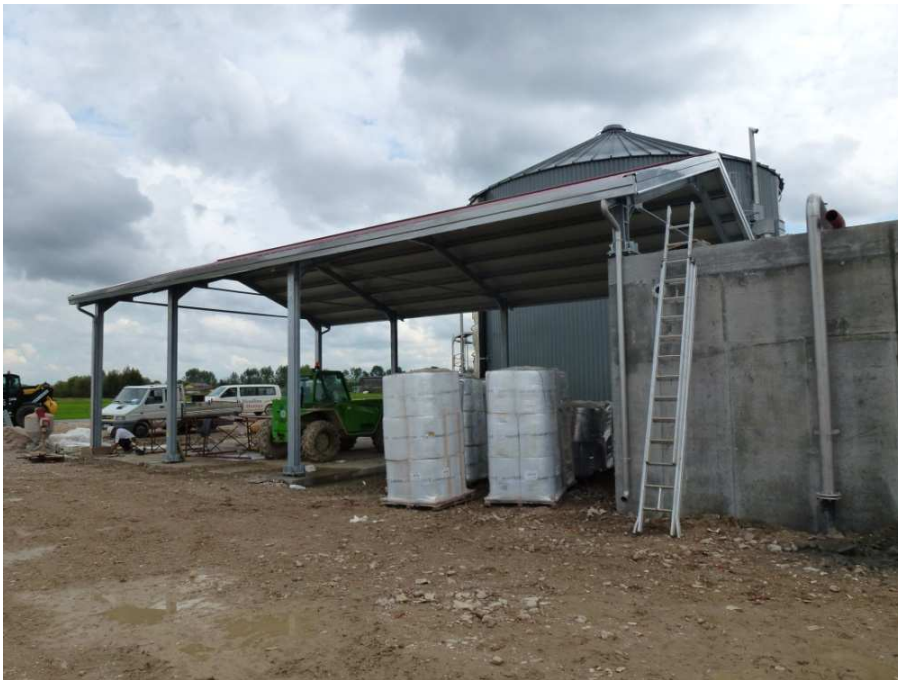
Figura 10.2 - Locale uffici, piccola officina e vasca di premiscela.
