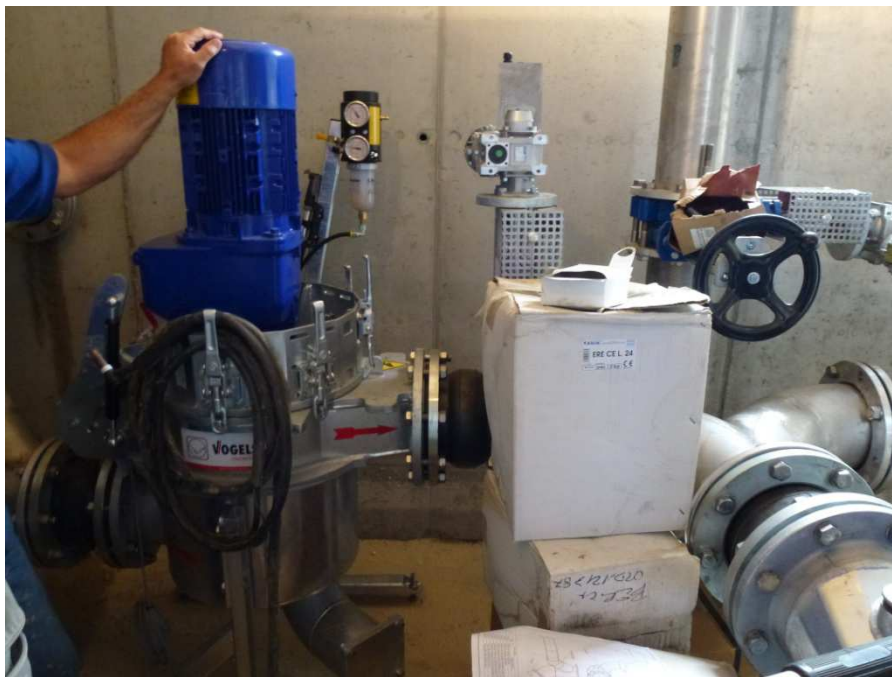
Figura 10.3 - Trituratore, posto nel locale tecnico.
