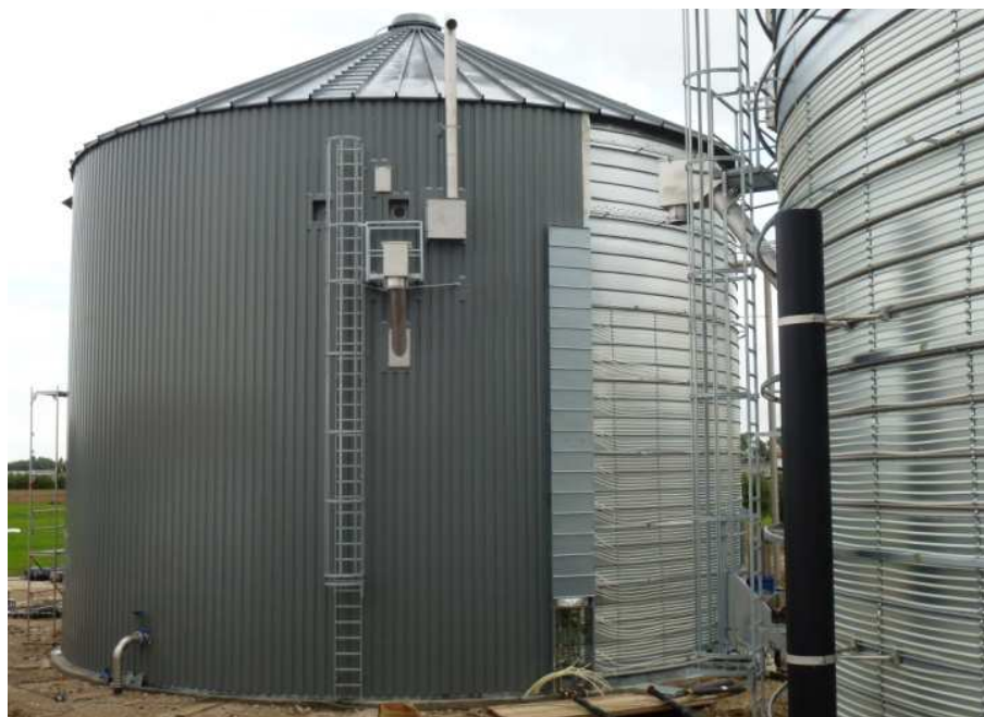
Figura 10.11 - Digestore parzialmente coibentato.
