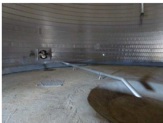
Figura 10.5 - Interno del digestore.
