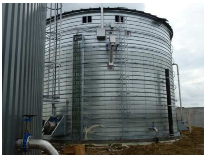
Figura 10.9 - Digestore non coibentato.
