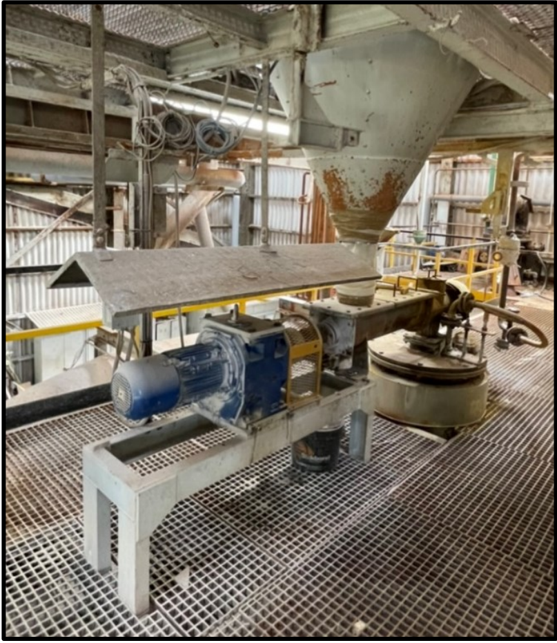
Sistema di carico delle materie prime: KCl e H_2SO_4
