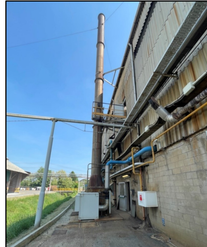
Sistema di scarico dei gas combusti
