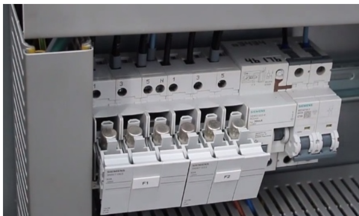
Figura 5.10: Scollegamento elementi sensibili al test di tensione
