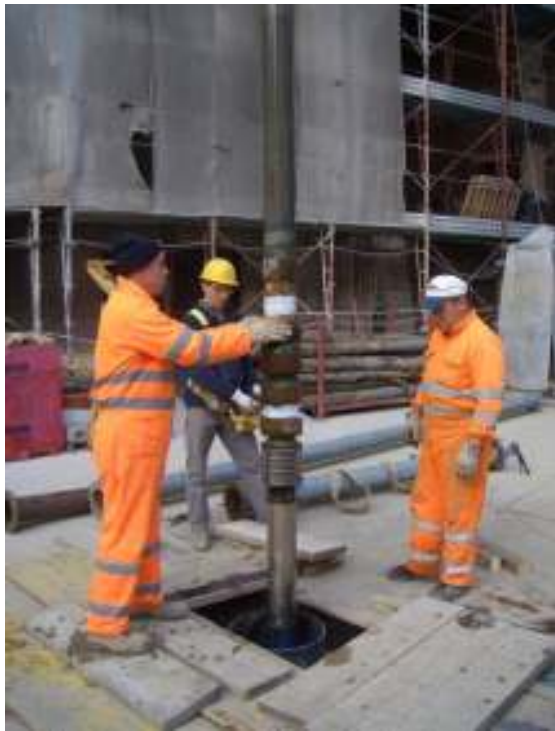
Figura 52: Collocazione della pompa in PR
