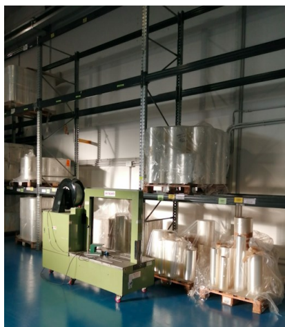
Figura 6.4 Scaffalatura SMA destinata allo stoccaggio di bobine
