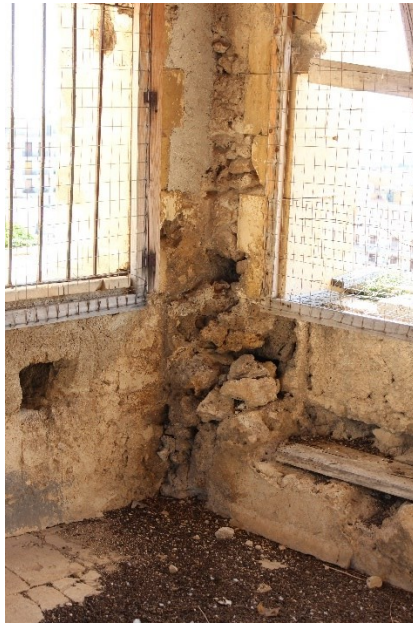
Figura 3.16 - Campanaria, forte degrado dei materiali
