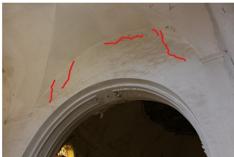
Figura 3.21 - Stato fessurativo arco primo livello
