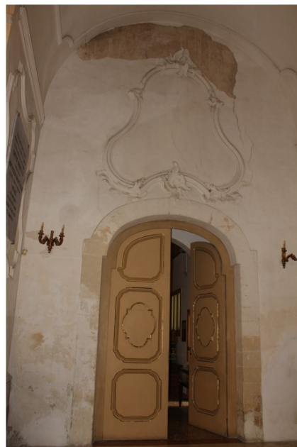
Figura 3.17 - Distacco di intonaco, alterazione cromatica
