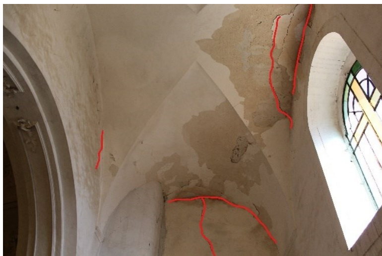
Figura 3.20 - Stato fessurativo volta a botte secondo livello
