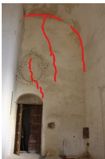
Figura 3.19 - Fessurazione dell'imposta della volta a crociera, ultimo livello
