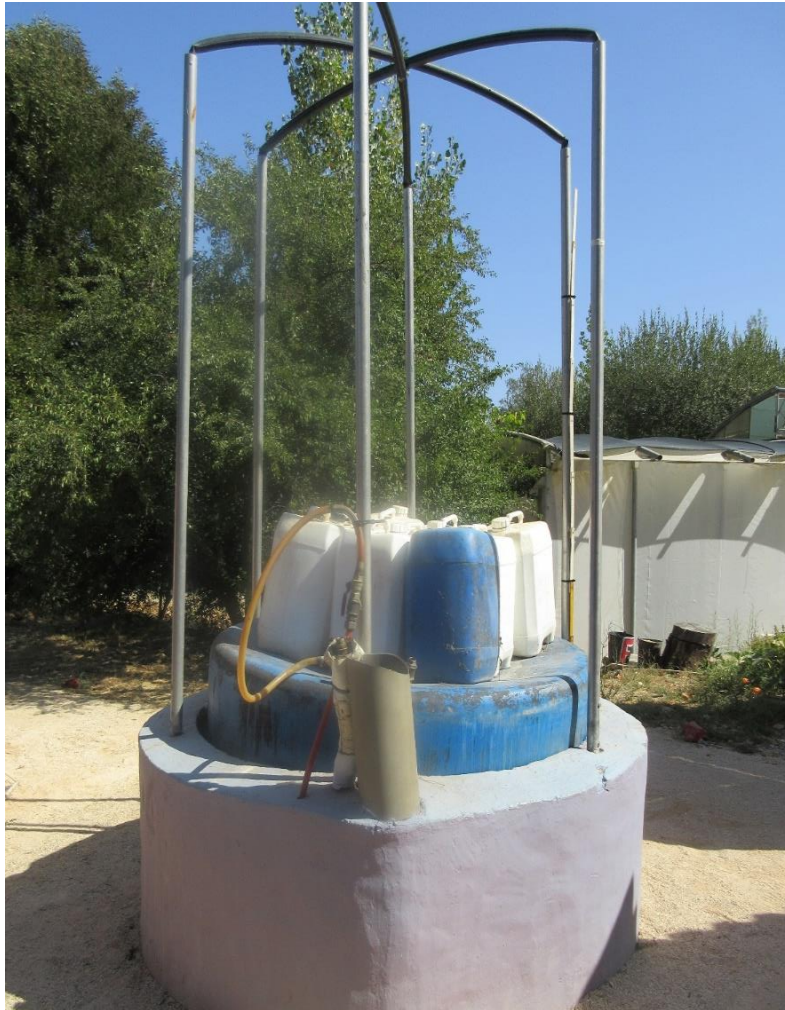
Figura 18. Sistema de produção de biogás na Aldeia Solar de Tamera que permite o funcionamento da cozinha durante 10-12 horas [dia 25 de agosto de 2017, Sofia Zanotti].
