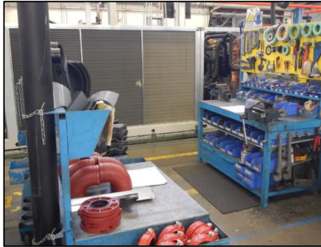
Figura 4.17: Postazione IMI in cui si nota il carrello degli asservitori pronto con flange, gomiti e gusci termoformati per l'impianto idrico (Fonte interna MEHITS)
