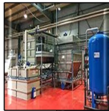
Impianto di depurazione
