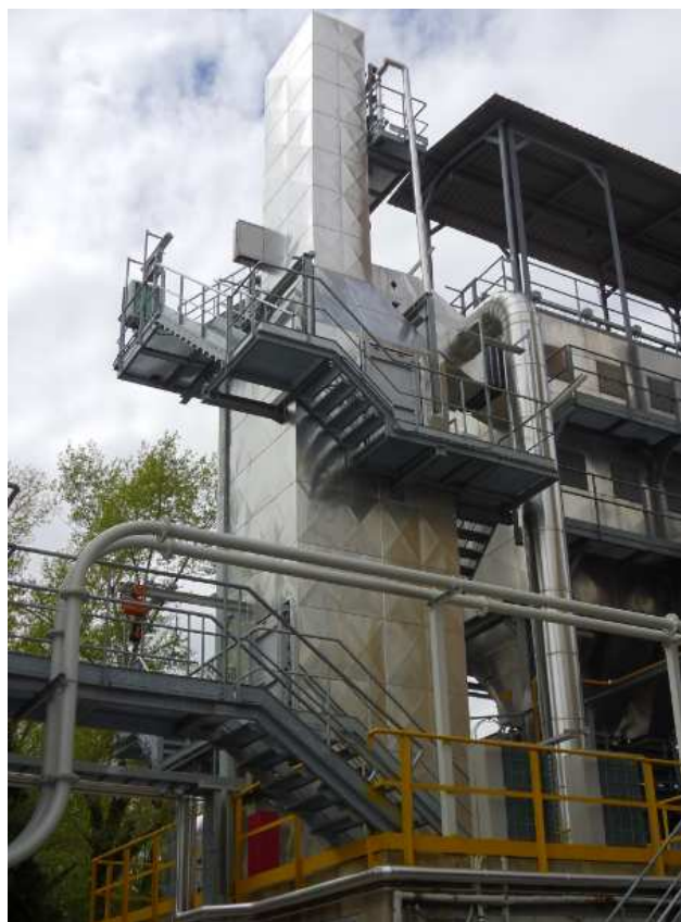
Figura 4.2. Reattore catalitico SCR della Linea 2 (a destra si nota il filtro a maniche).
