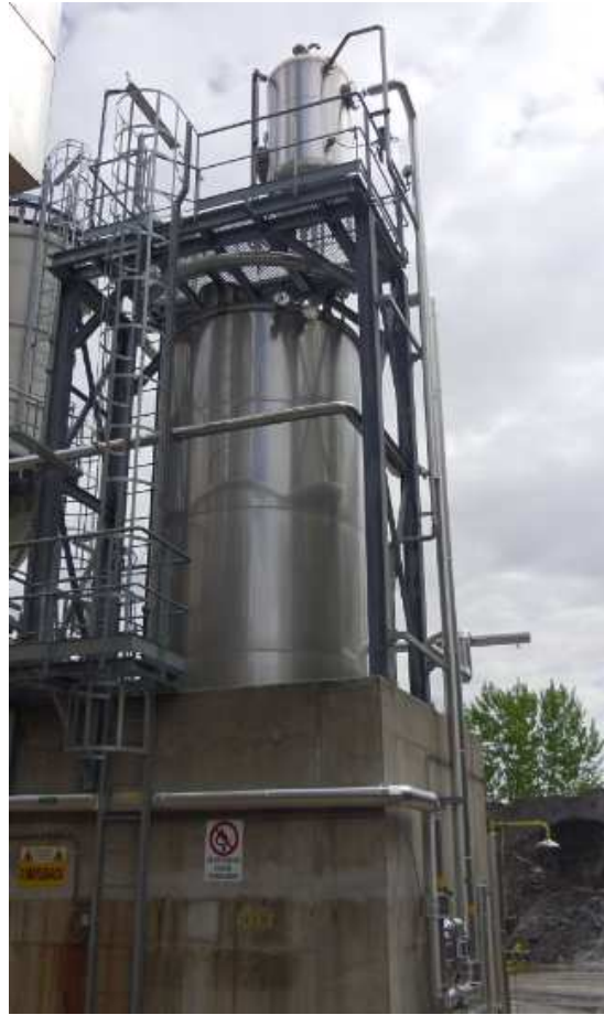
Figura 4.1 Serbatoio di stoccaggio della soluzione ammoniacale. In alto è posizionato il serbatoio di guardia idraulica.
