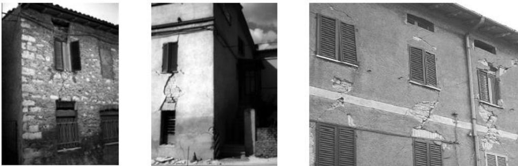
Figura 4-15: esempi di danni in fasce di piano dovuti a sisma in edifici esistenti in muratura semplice
