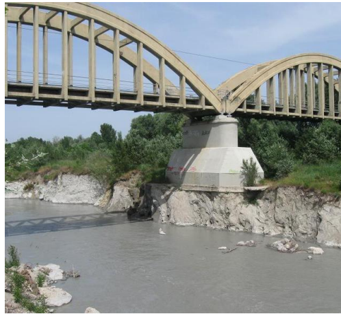
Figura 42 Erosione delle fondamenta di una struttura.
