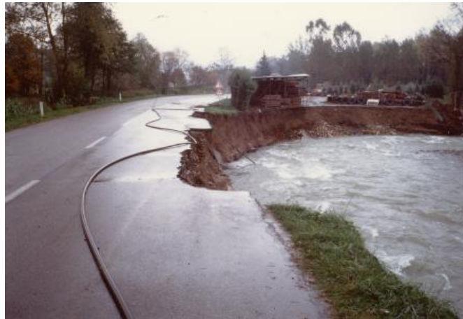
Figura 43 : Erosione spondale con relativo danno della strada.
