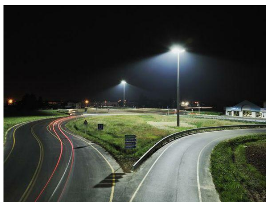
Figura 2.7 Illuminazione stradale con lampade ad alta resa cromatica
