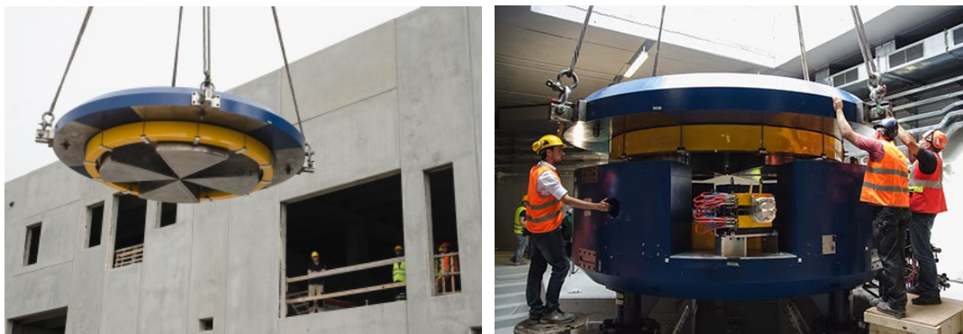
Figura 2 – Due fasi della procedura per collocare il ciclotrone nella sua sede, nel nuovo edificio destinato alla facility SPES ai LNL.
