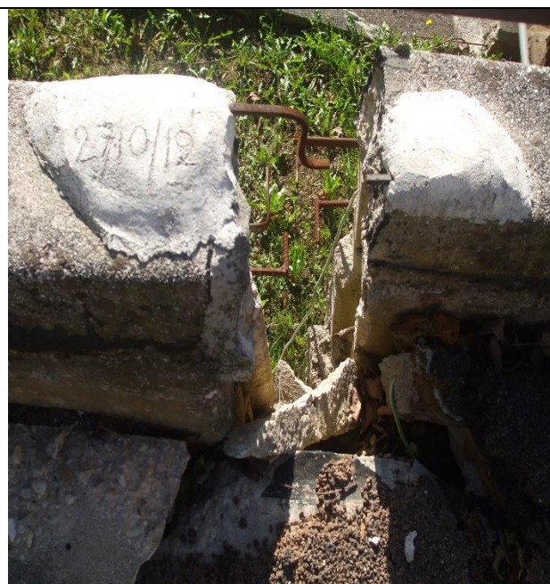
Foto 2.2, Lesione muretto abitazione
