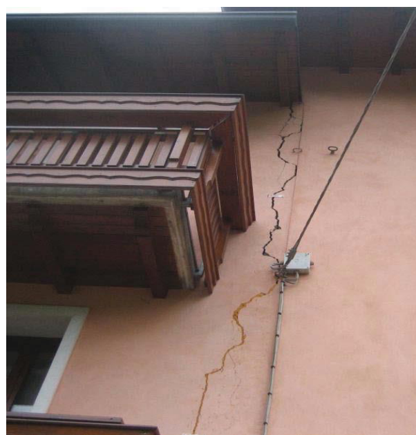
Foto 2.4, Lesioni muro abitazione
