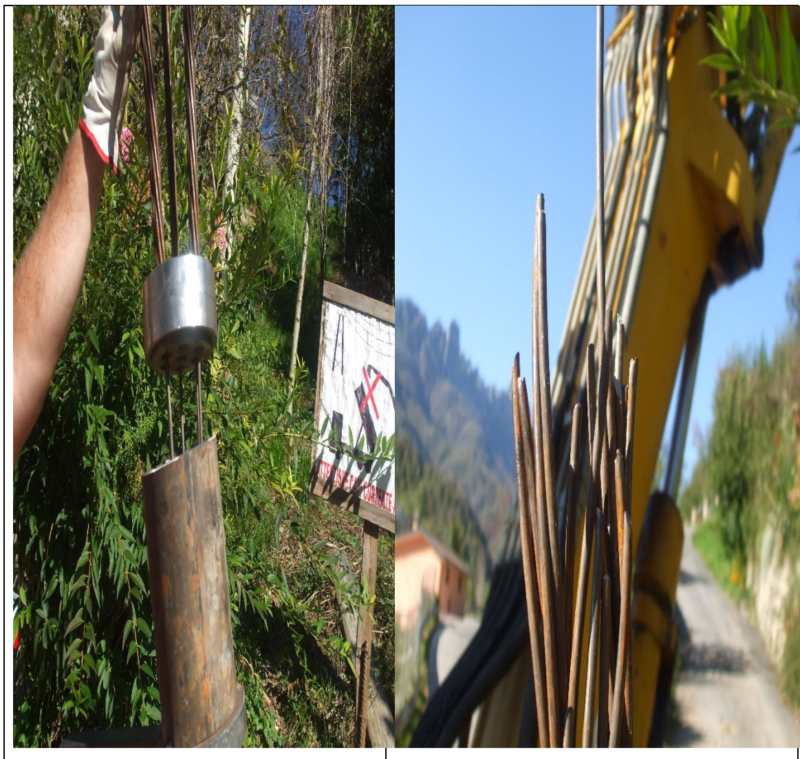
Foto 4.6, Rottura trefoli in ancoraggio II
