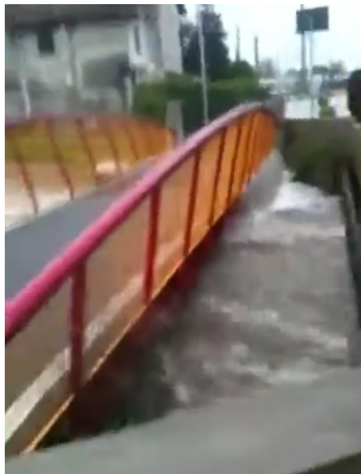
Figura 4: Esondazione sul ponte di Via XXX Ottobre in occasione dell'evento del 2012. (Fonte: estratto reportage Pio Dal Cin)
