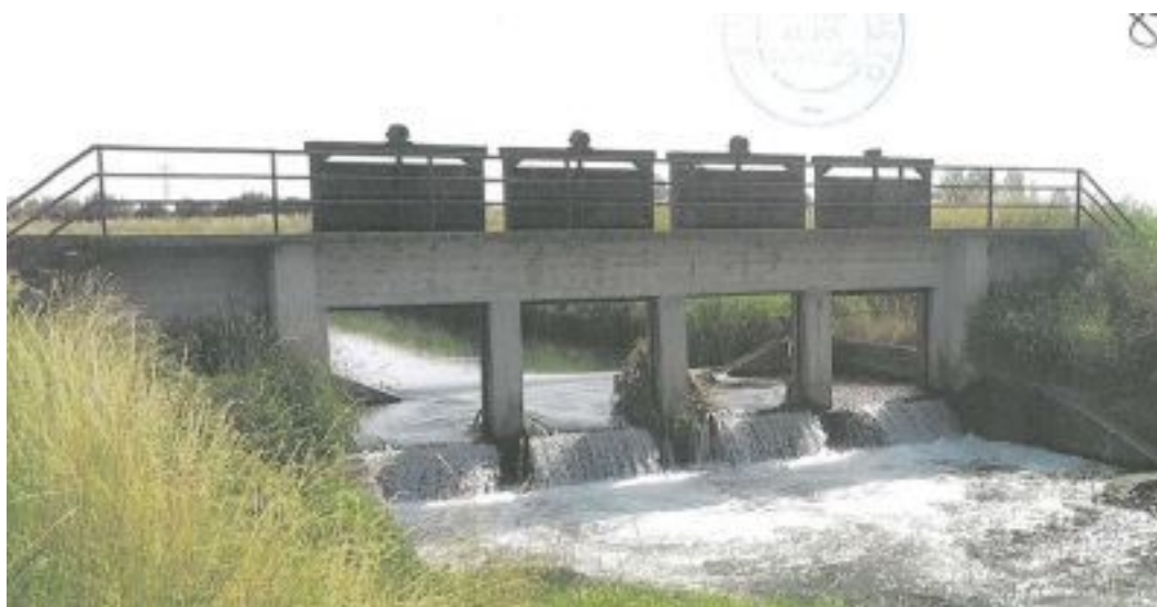
Figura 15: Sostegno irriguo a valle di via XXX Ottobre. (Fonte: "Relazione Generale e Illustrativa - sistemazione idraulica canale Codolo").
