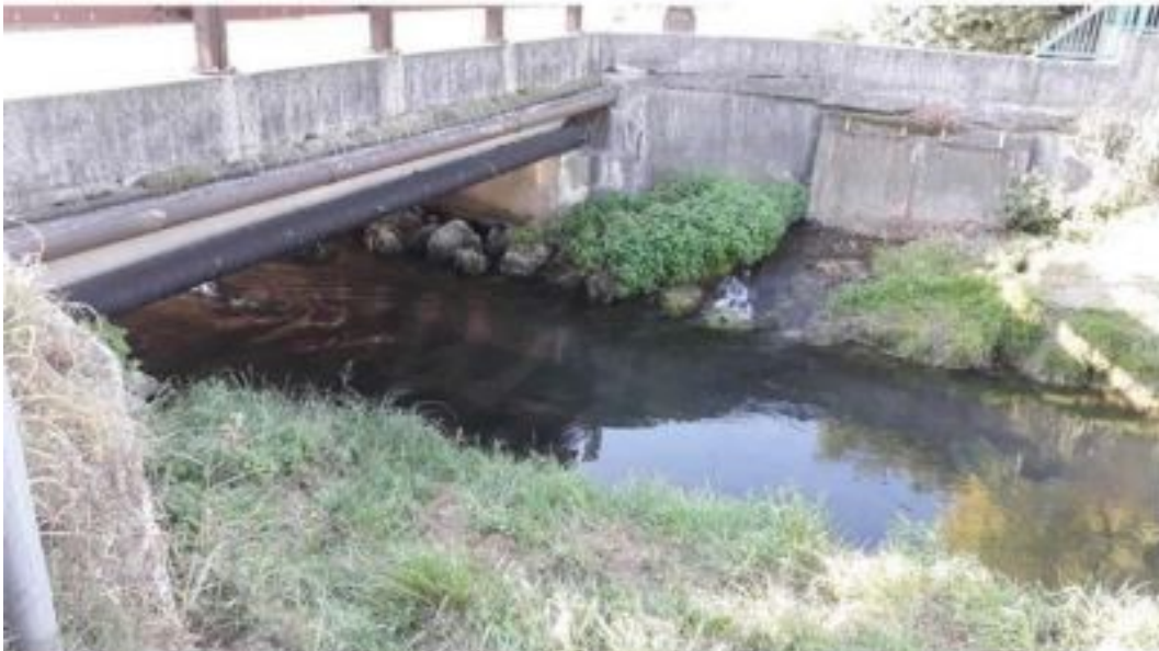
Figura 3: Ponte Via XXX Ottobre. (Fonte: Relazione Generale Ed Illustrativa Sistemazione Idraulica Canale Codolo.)
