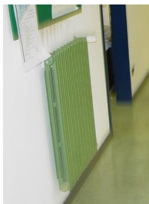
Figura 9 Terminale d'impianto edificio Stecca 1
