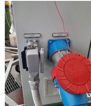
Prese "dinamo" e "servizi" lato quadro elettrico
