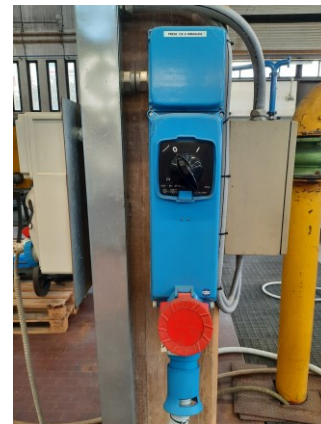
Presa a muro alimentazione quadro elettrico
