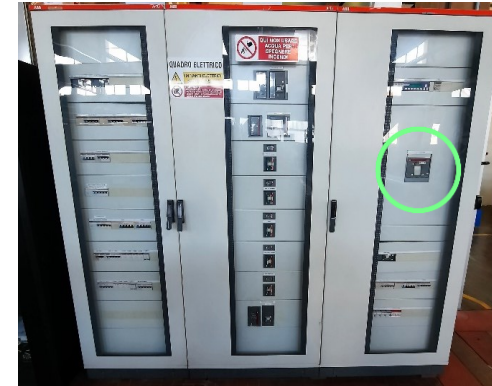
Quadro elettrico generale
