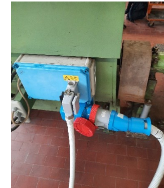
Prese "dinamo" e "servizi" lato motore elettrico
