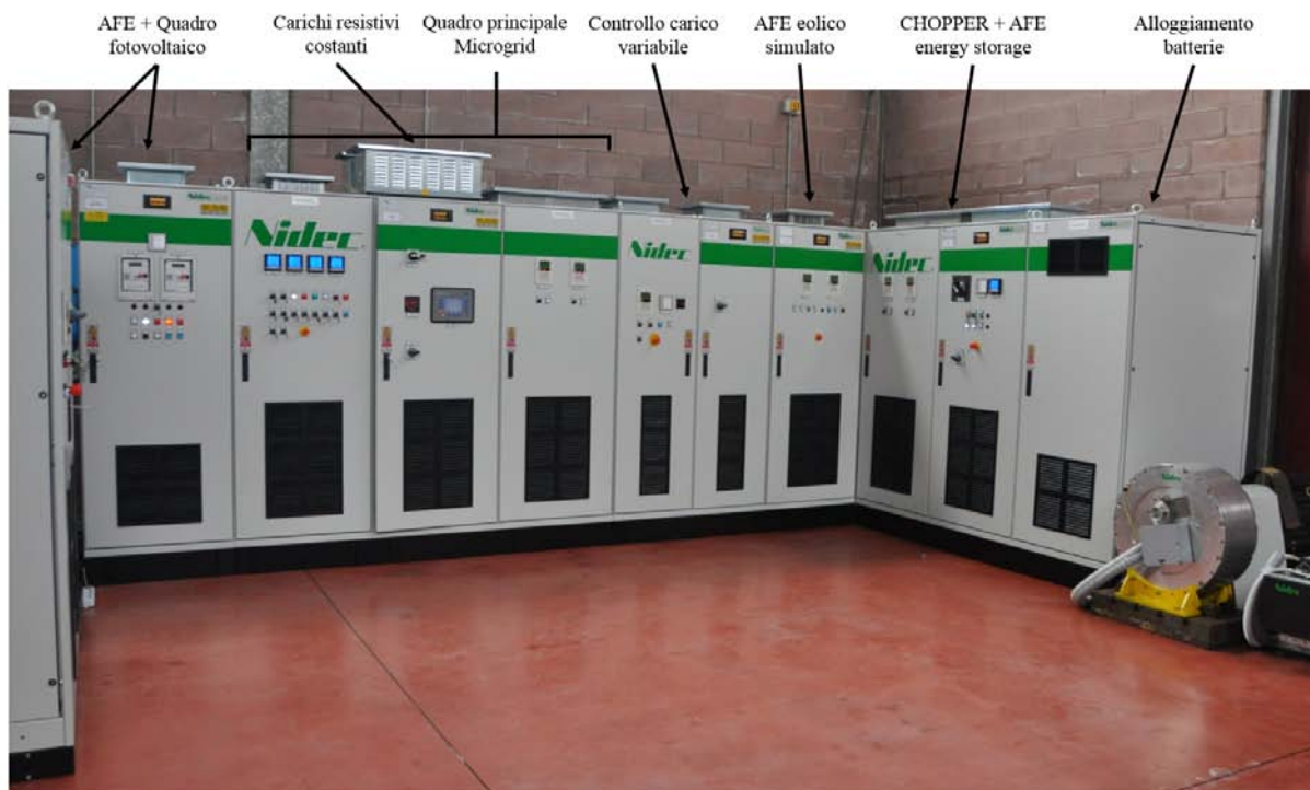
Figura 5.1: Quadri elettrici e apparati di conversione della microgrid
