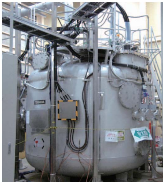
Figura 3.15: Criostato dell'impianto SMES installato nell'impianto idroelettrico di Hosoo in Giappone [Nikko Power Generation]. Capacità energetica: 19MJ ( \sim 5kWh) - Corrente nominale: 1350A - Temperatura di esercizio: 4,2K - Massima induzione: 4,4T - Massima potenza erogabile: 10MW
