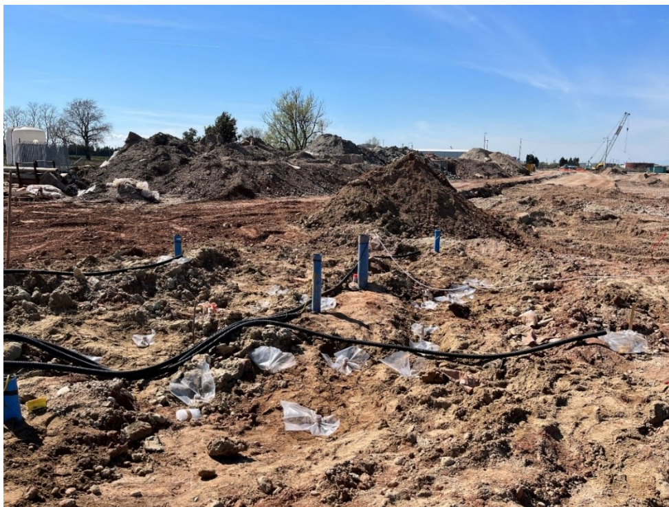
Figura 24: Tubi sonici con disposizione a rombo e rettangolare, coperti con telo impermeabile trasparente.
