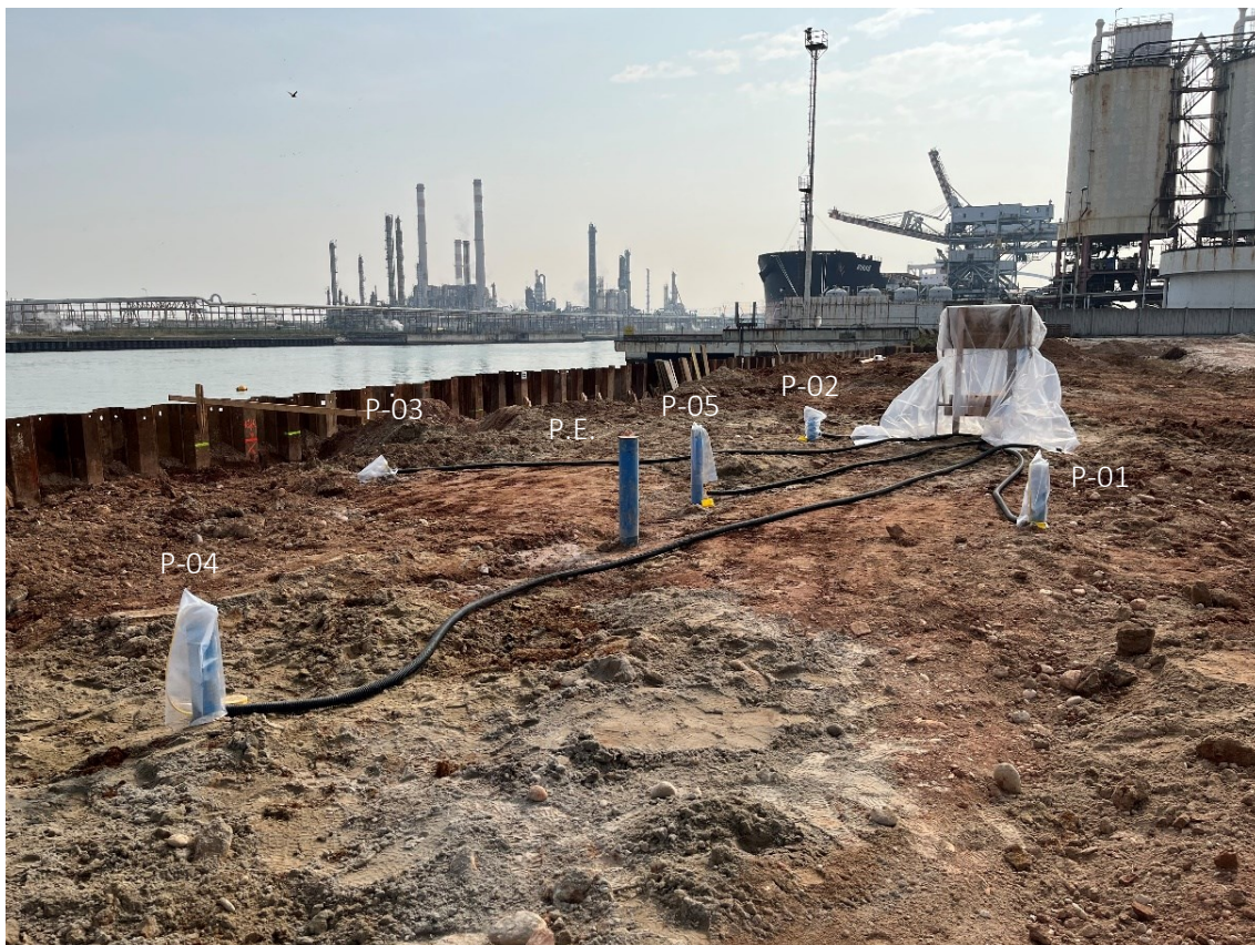
Figura 26: Immagine dei piezometri installati, coperti da telo impermeabile trasparente e collegati alla postazione di raccolta dati.
