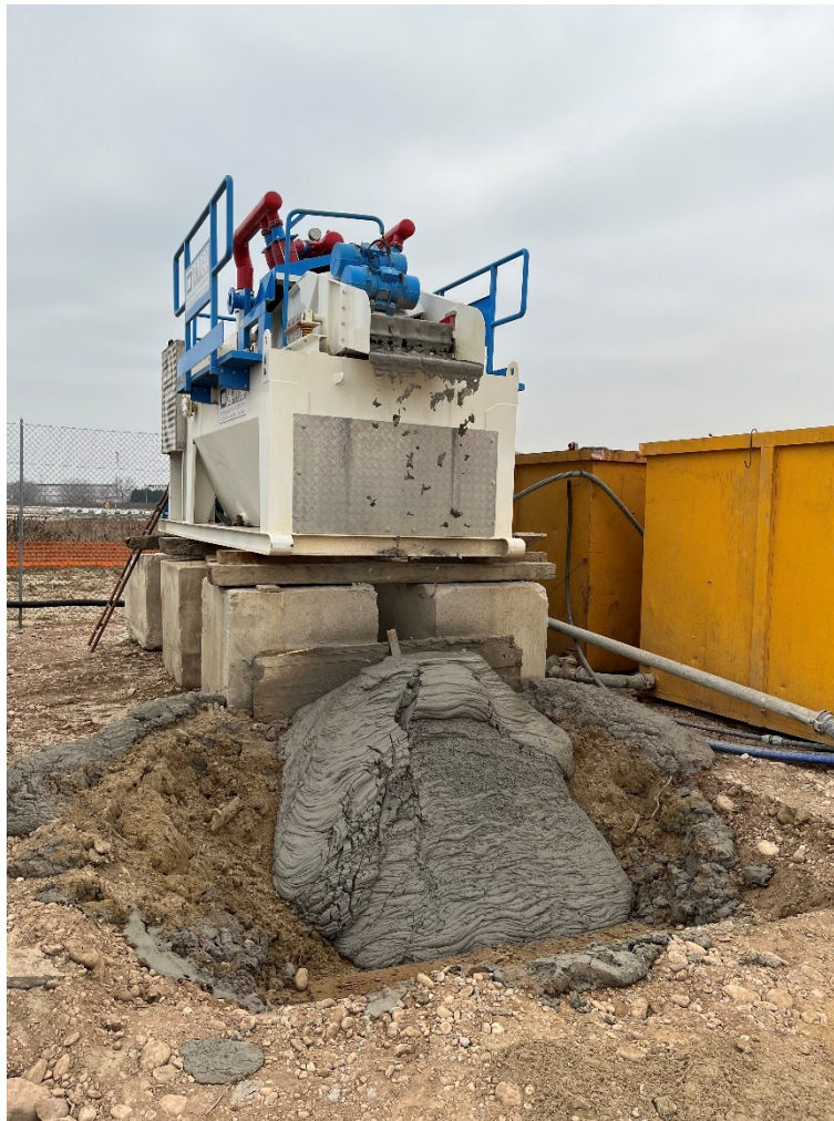
Figura 23: Impianto di trattamento dei fanghi bentonitici, o dissabbiatore.
