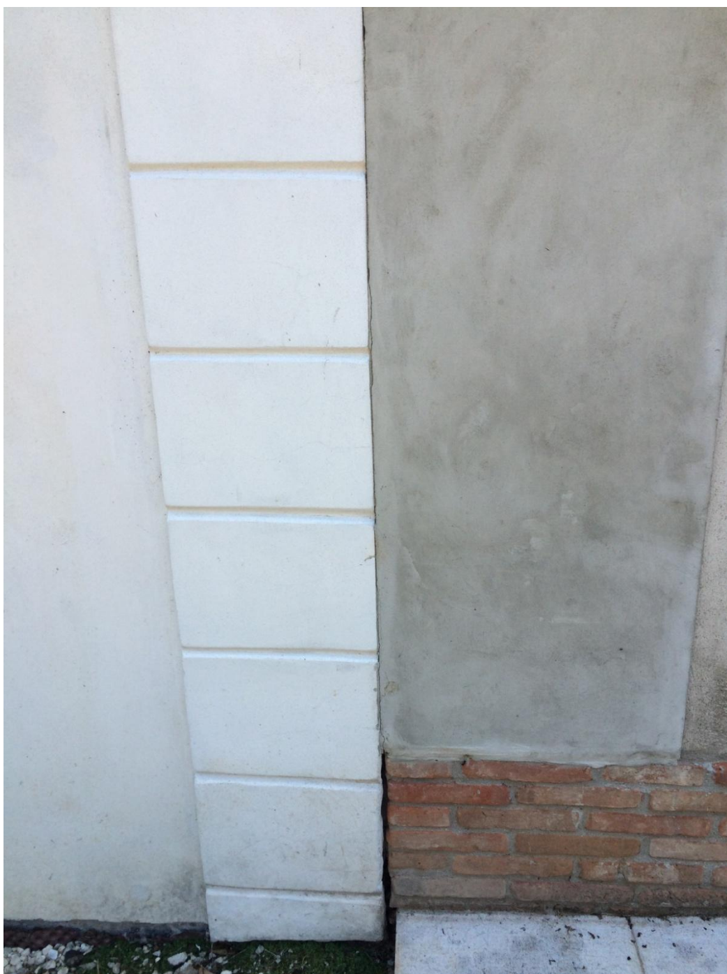
Foto 5 – Apertura tra due abitazioni rilevata nel settore 1 risalente all'evento del Febbraio 2014.
