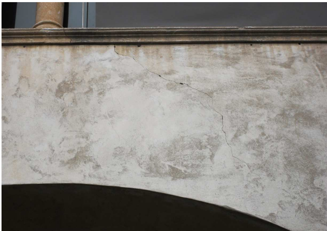
Fig.[5.40] Fessura n.1.
