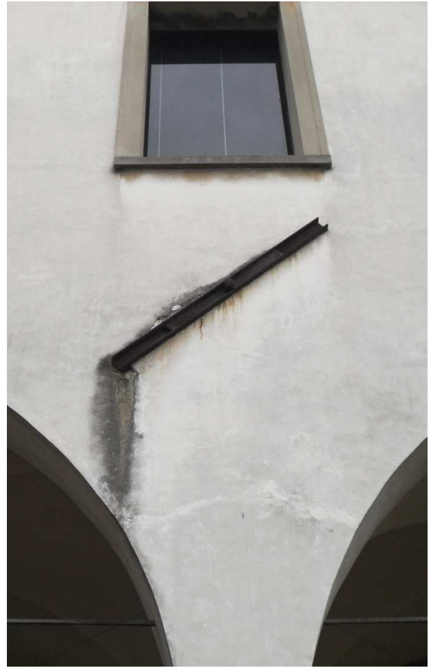
Fig.[5.56] Tirante situato nella facciata sud del Chiostro Maggiore.
