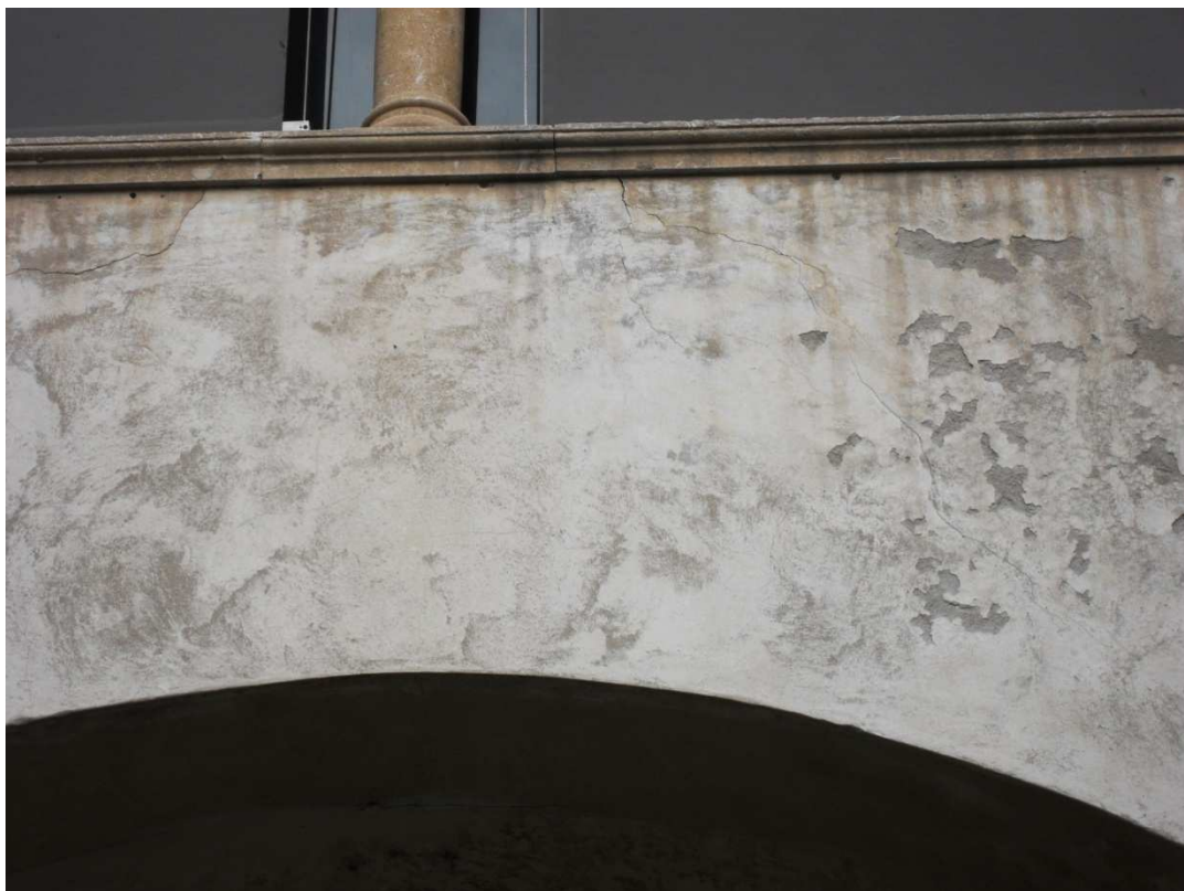
Fig.[5.41] Fessura n.2.
