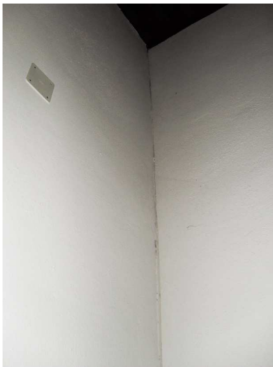
Fig.[6.15] Fessura passante all'interno.
