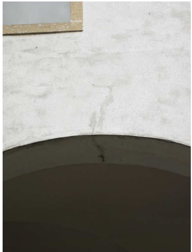
Fig.[5.52] Fessura n.6.
