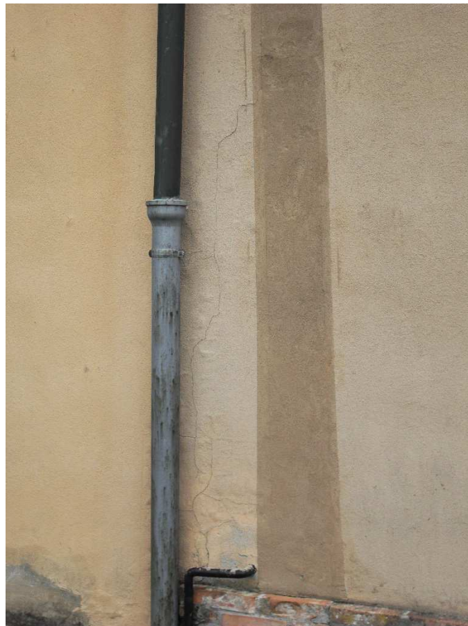
Fig.[6.33] Fessura n.1.
