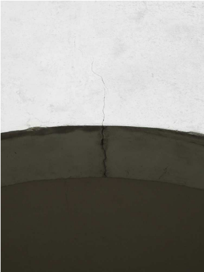
Fig.[5.49] Fessura n.3.
