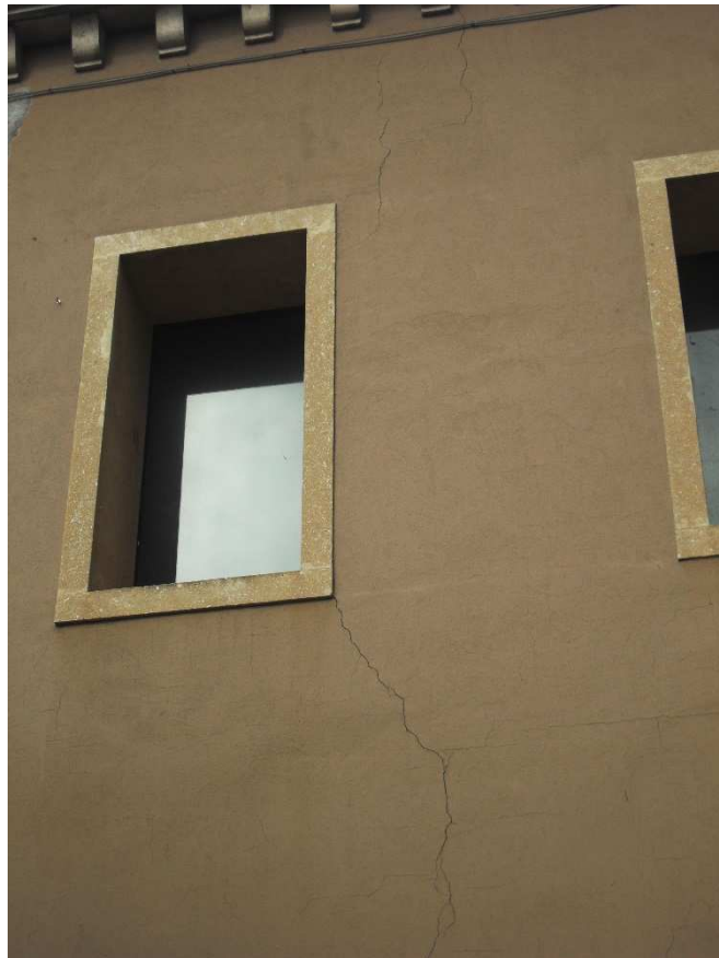
Fig.[6.24] Fessura n.1.
