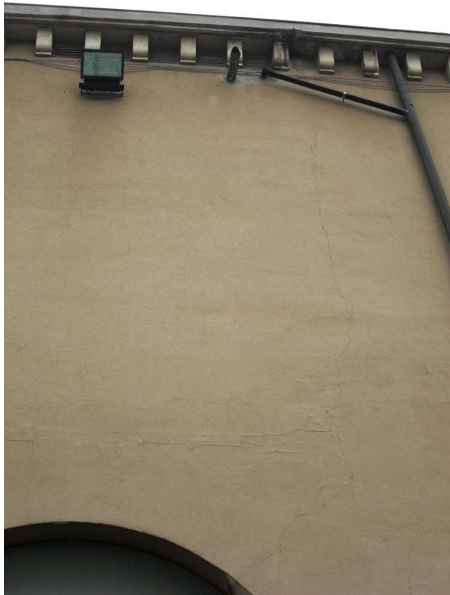
Fig.[6.17] Fessura n.2.
