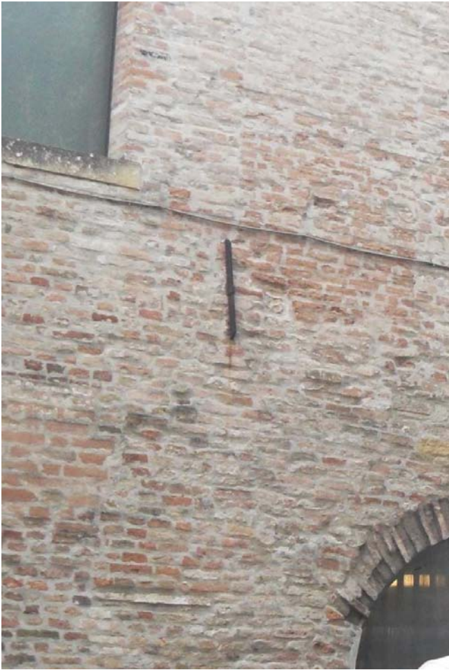
Fig.[5.55] Tirante situato nella facciata nord.
