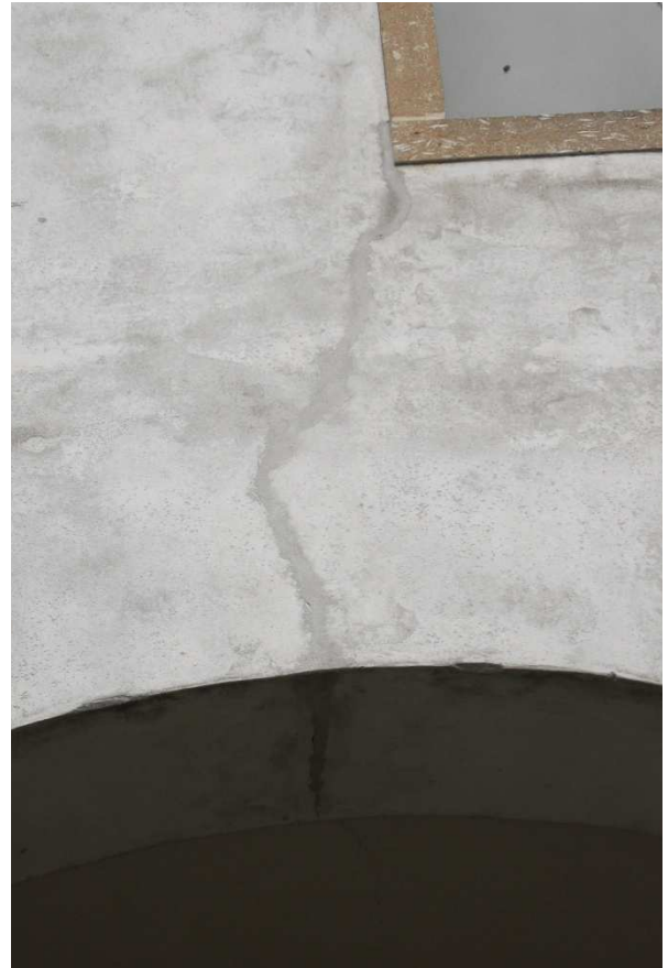
Fig.[5.50] Fessura n.4.
