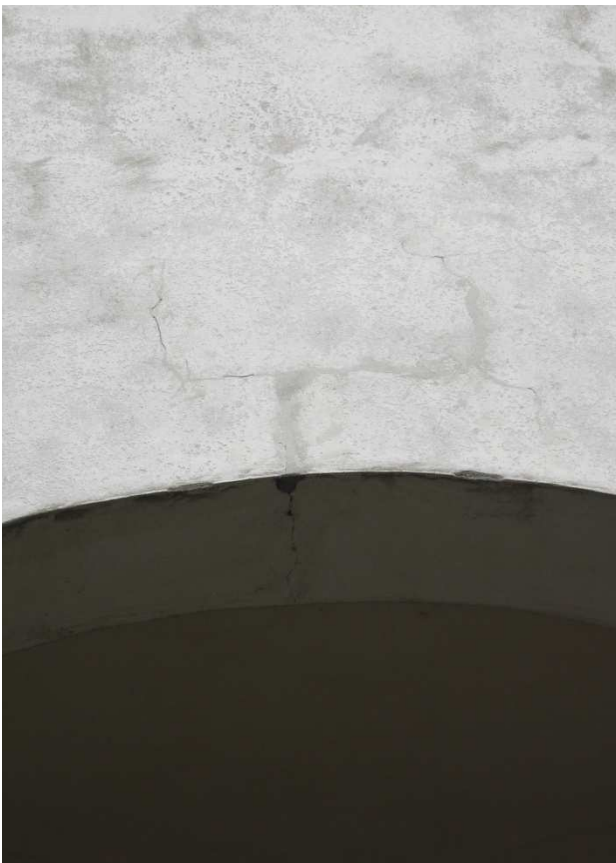
Fig.[5.51] Fessura n.5.
