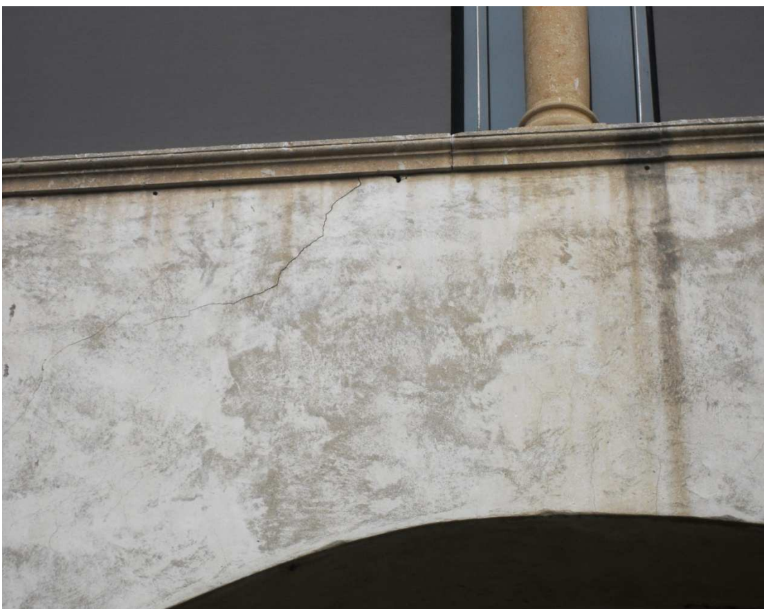
Fig.[5.44] Fessura n.5.
