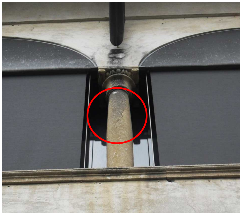
Fig.[5.38] Fessura in uno dei pilastrini che compongono in loggiato al piano primo del Chiostro Maggiore.
