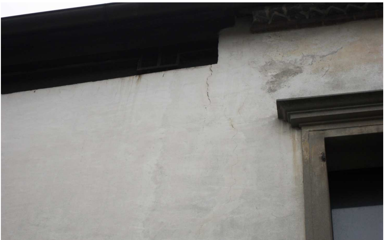
Fig.[6.8] Fessura n.3.
