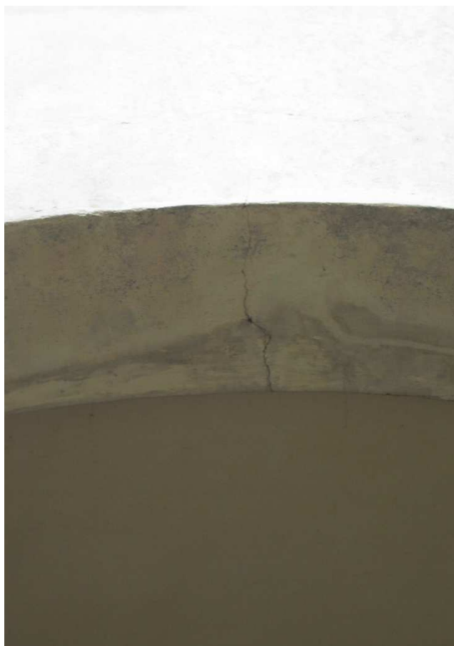
Fig.[5.47] Fessura n.1.
