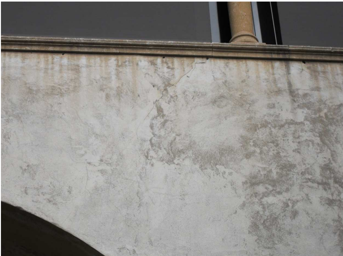
Fig.[5.43] Fessura n.4.
