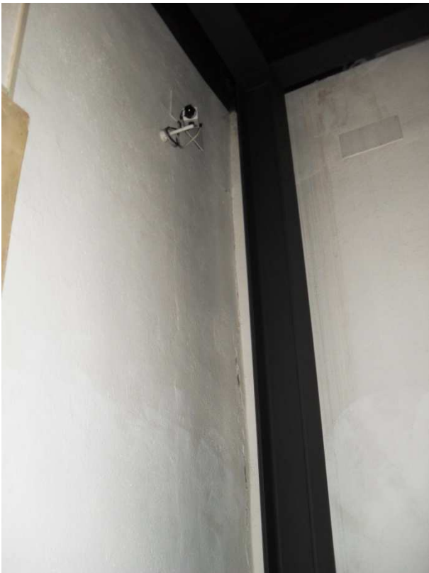
Fig.[6.5] Fessura n.1.
