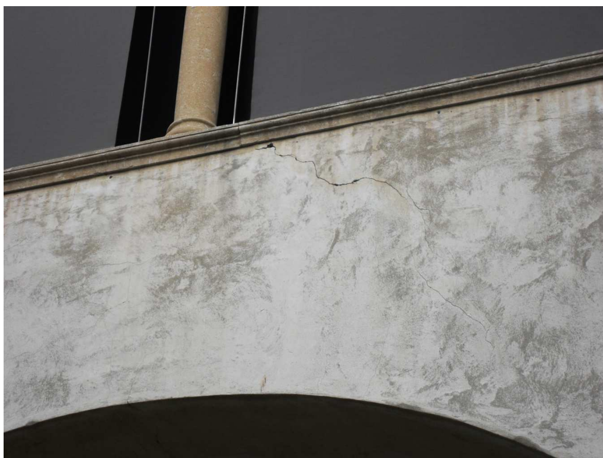
Fig.[5.42] Fessura n.3.
