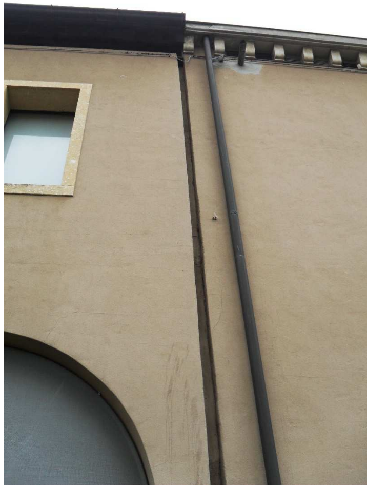
Fig.[6.14] Fessura n.1.
