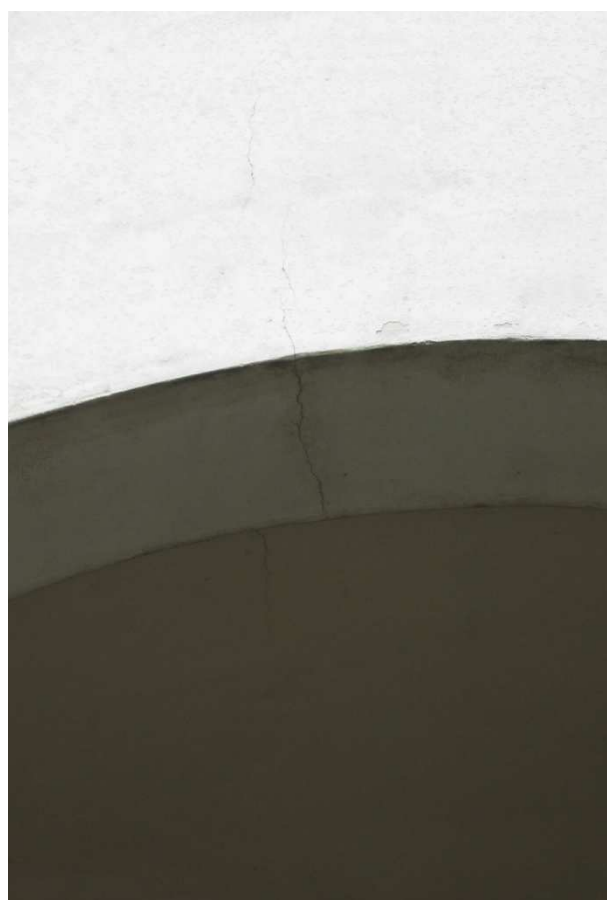
Fig.[5.48] Fessura n.2.
