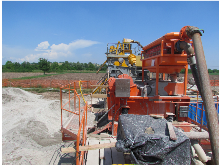
Figura 33 Panoramica di cantiere: a destra l'impianto di separazione, a sinistra il piazzale, dove è temporaneamente stoccato lo smarino.
