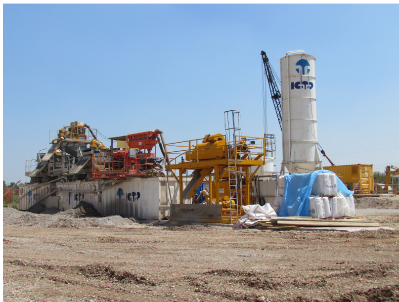
Figura 7 Impianto di separazione
