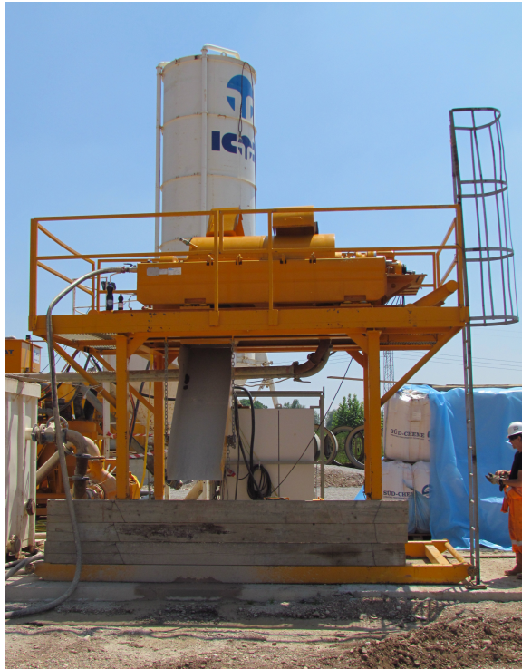
Figura 12 Particolare dell'impianto di separazione: la centrifuga.
