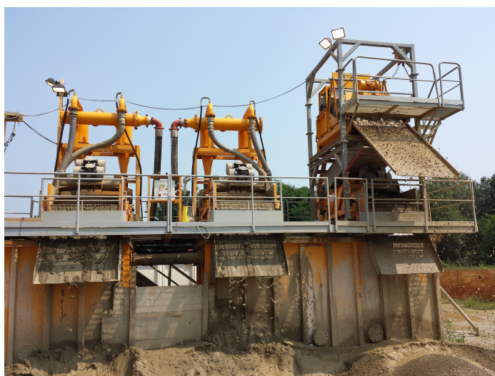
Figura 8 Particolare dell'impianto di separazione dello smarino, a sinistra due unità che separano la sabbia in parallelo, a destra per la ghiaia anch'esse in parallelo ma disposte una sopra l'altra
