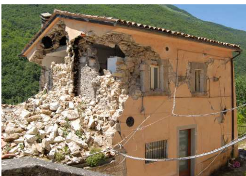
(a) U.S. 109, ribaltamento fuori piano della parete est.
