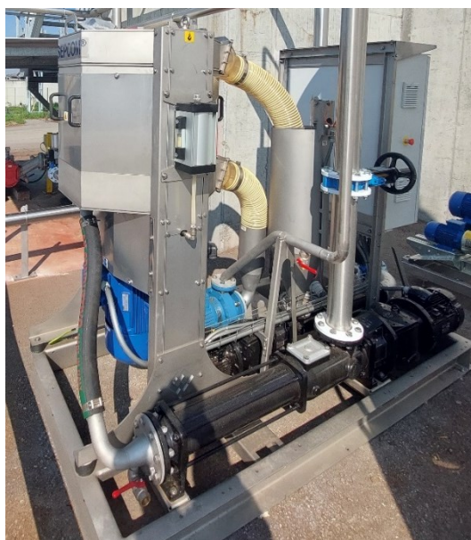
Figura 3.4: filtro Saveco che chiarifica il digestato
