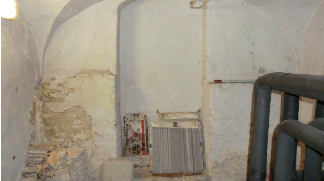
Figura 6.5: Rilievo degrado, piano interrato
