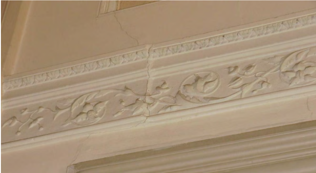
Figura 6.7: Rilievo degrado, piano primo
