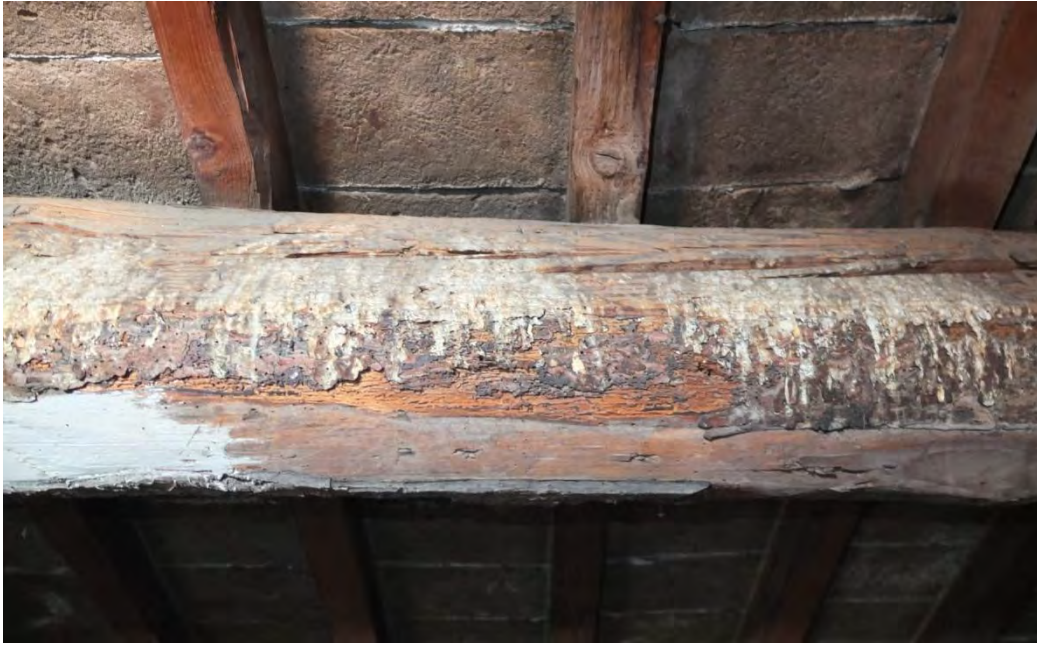
Figura 6.13: Rilievo degrado, sottotetto
