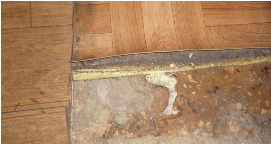
Figura 6.8: Rilievo degrado, piano primo
