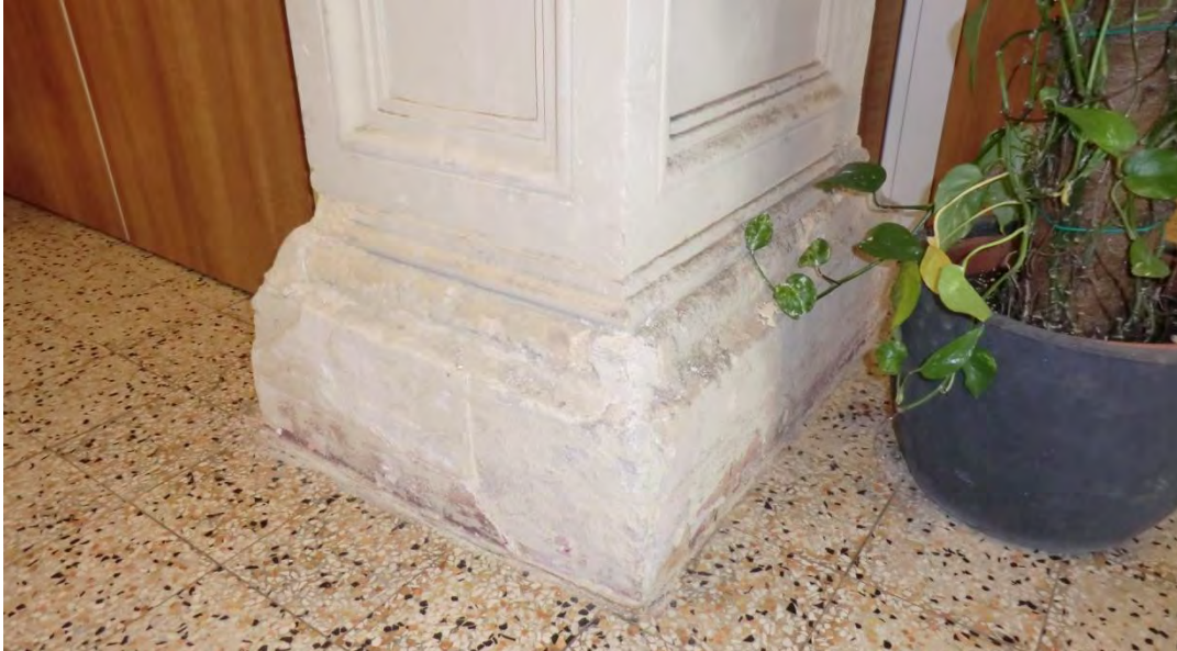
Figura 6.3: Rilievo degrado, piano terra
