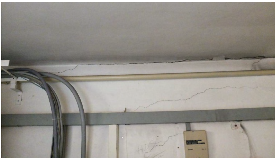
Figura 6.9: Rilievo degrado, piano ammezzato
