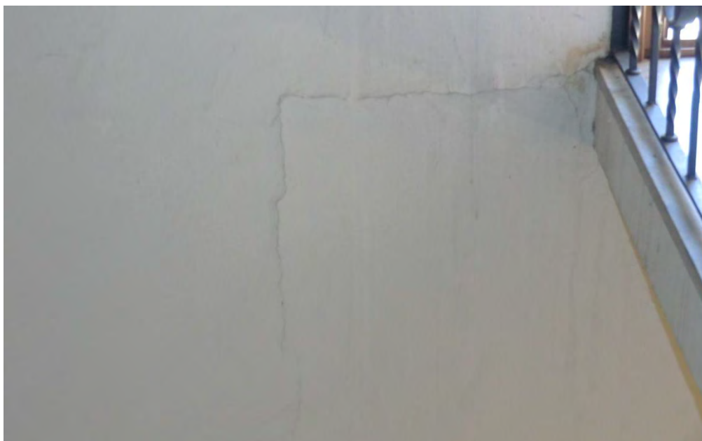
Figura 6.11: Rilievo degrado, piano secondo
