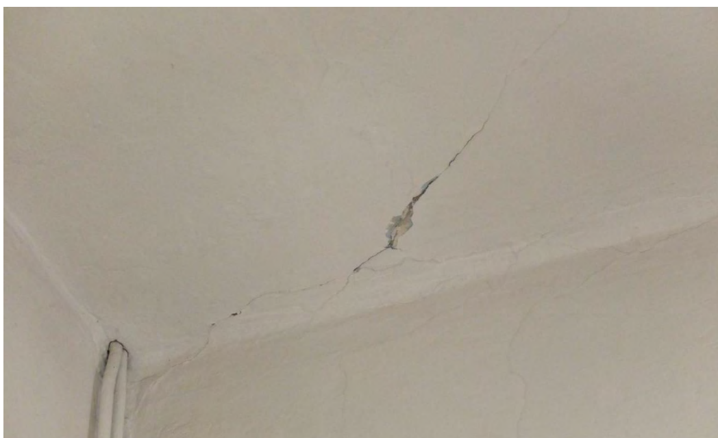
Figura 6.12: Rilievo degrado, piano secondo
