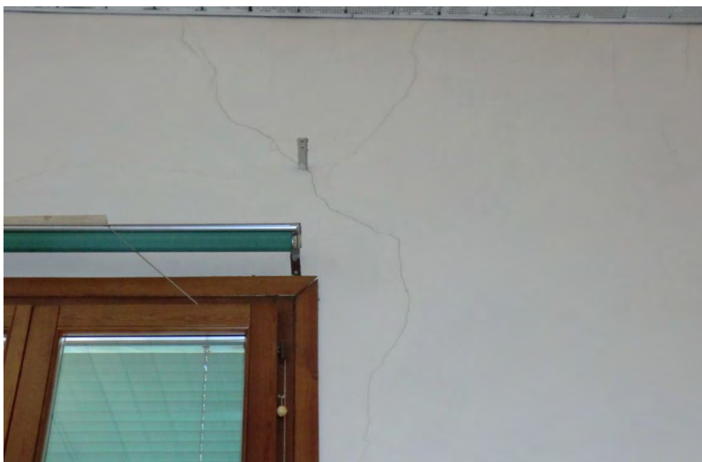
Figura 6.10: Rilievo degrado, piano secondo
