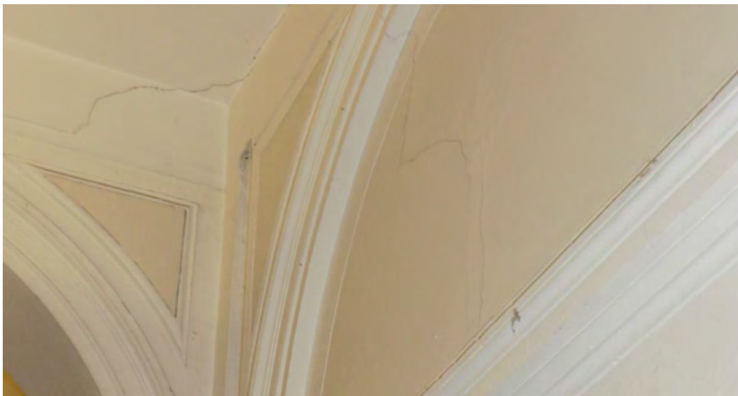
Figura 6.6: Rilievo degrado, piano primo
