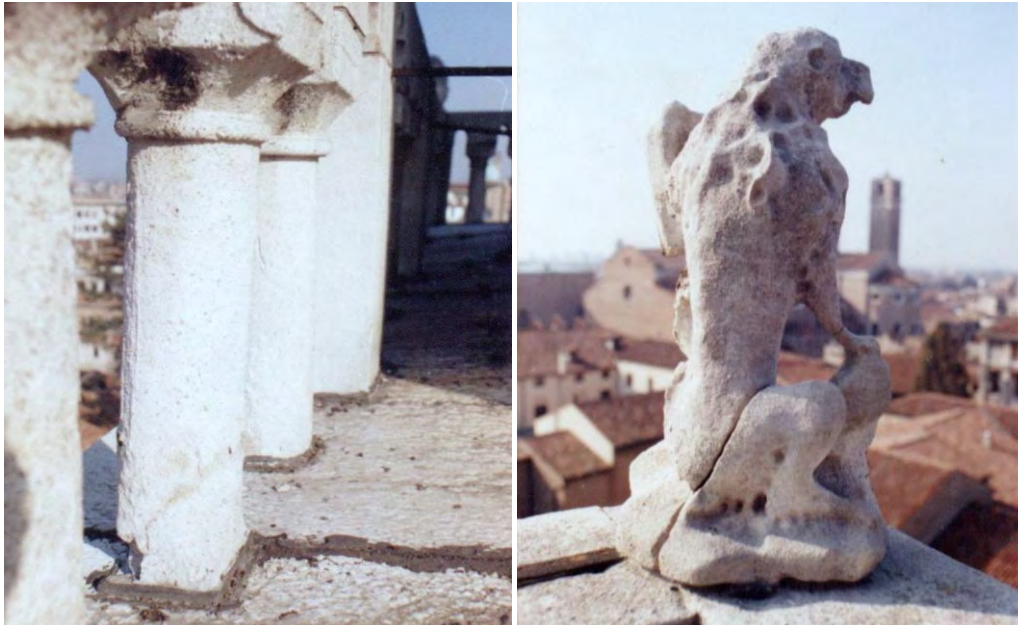
Figura 2.13: Elementi di degrado rilevati durante il sopralluogo del 1988-89
