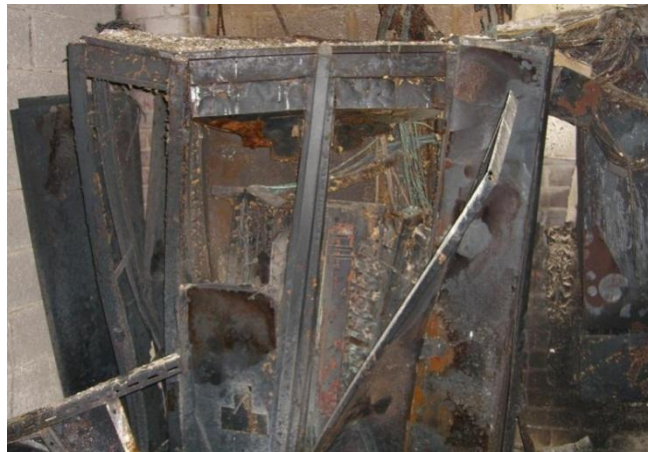
Figura 2.7: cabina elettrica dello stabilimento dopo l'incendio
