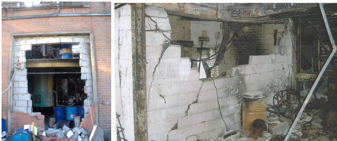
Figura 2.5: effetto dell'esplosione sulla struttura dello stabilimento
