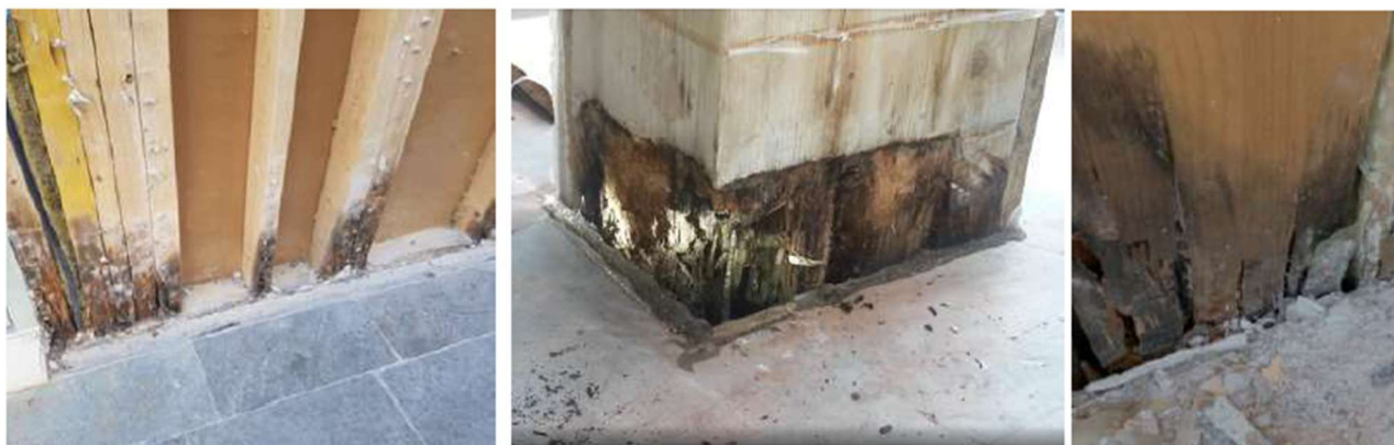
Figura 104: problemi di marcescenza alla base per errata posa dei materiali
