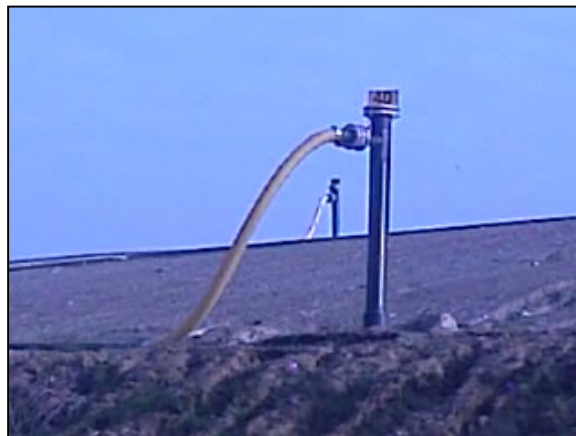
Fig. 5.1 – Pozzo di captazione verticale collegato alla linea secondaria
