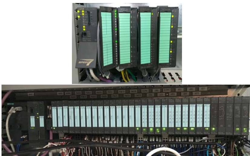
Figura 2.17: PLC: sopra primo PLC, sotto secondo PLC
