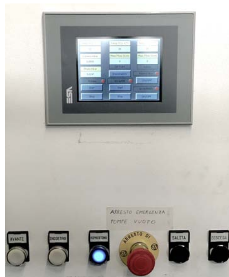
Figura 3.5: Pannello operatore VCS
