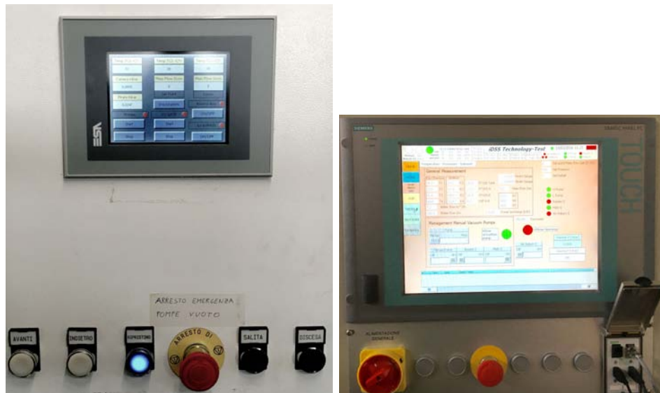
Figura 2.16: Pannello operatore: a sinistra primo PLC, a destra secondo PLC
