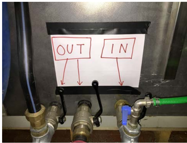
Figura 2.10: Valvole di ingresso e uscita acqua dalla vasca
