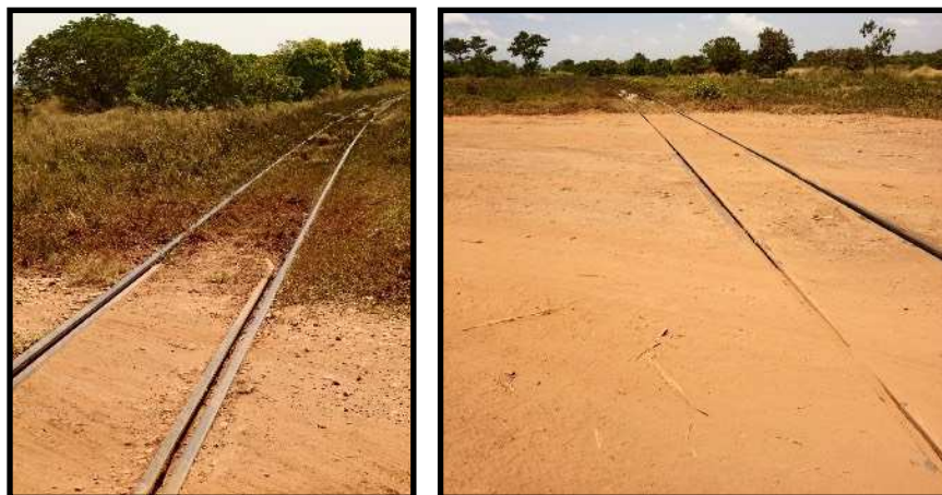
Figure 26 : Photographies des rails abandonnés dans le périmètre sucrier de la SN SOSUCO
