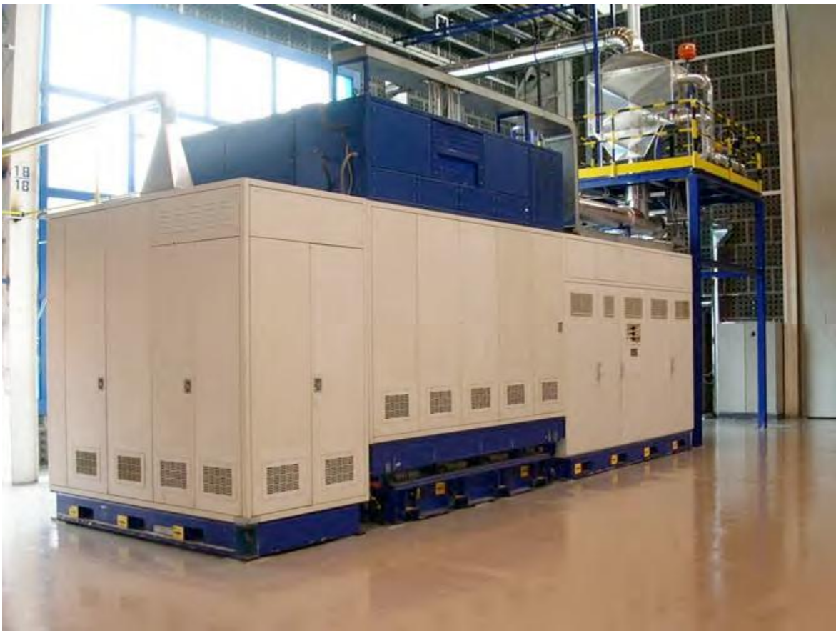
Figura 2 CHP100 SOFC Generator, è un prototipo della Siemens-Westinghouse da 123,6 KW costruito a Torino. È progettato per la cogenerazione, fornisce quindi anche acqua calda alla temperatura di 85°C per un totale di 60kW termici. Lo stack è progettato per funzionare a 950°C. [Font: http://termserv.casaccia.enea.it/acca2/Orsello.pdf ]
