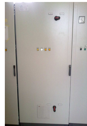
Illustrazione 5: Quadro elettrico inverter/soft-start
