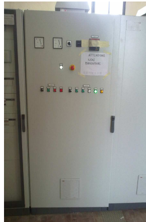
Illustrazione 3: Quadro elettrico idrovora 1
