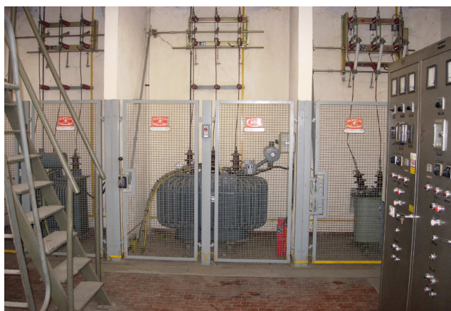
Illustrazione 7: da sinistra trasformatori TR1, TR2, AUX
