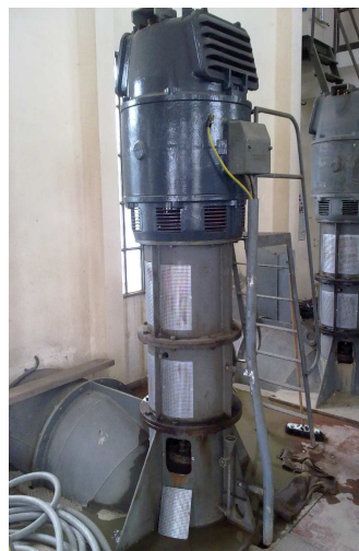
Illustrazione 10: Motore elettrico idrovora 2
