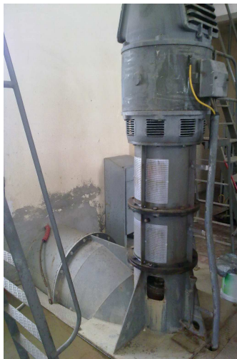
Illustrazione 9: Motore elettrico idrovora 1
