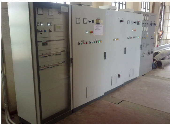
Illustrazione 1: Quadro elettrico per l'automazione
