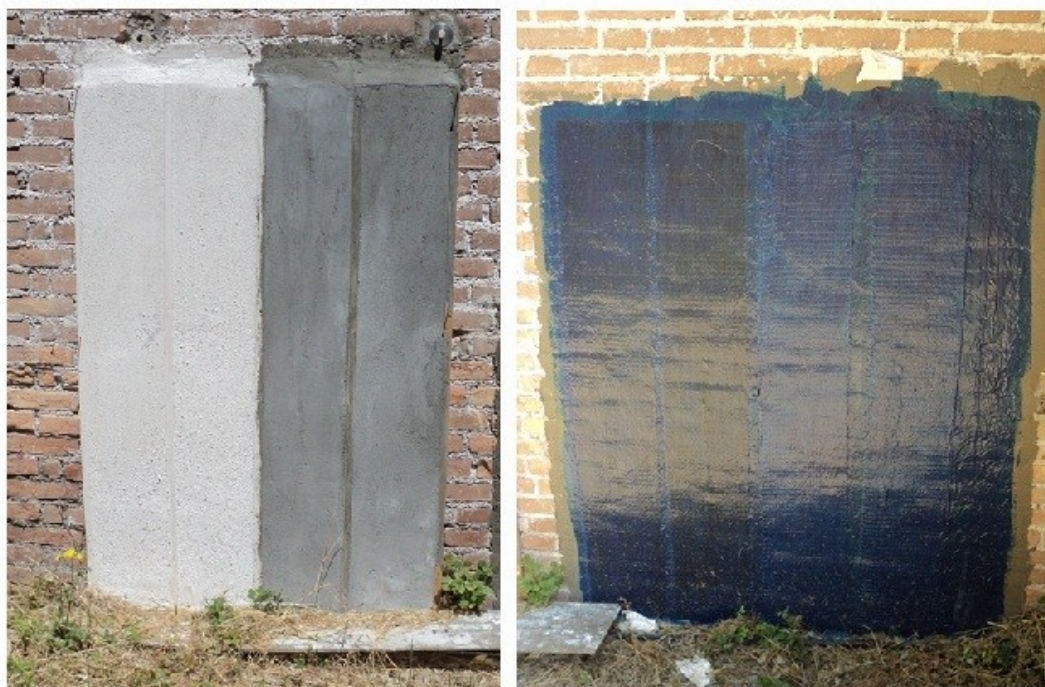
Figura 3.26: modulo B4 in mattone dopo l'applicazione dei materiali compositi; a sinistra l'applicazione di ALBARIA STRUTTURA e EMACO R955M , a destra l'applicazione di MBrace Saturant Adesivo con fibre di carbonio e con fibre di vetro ;
