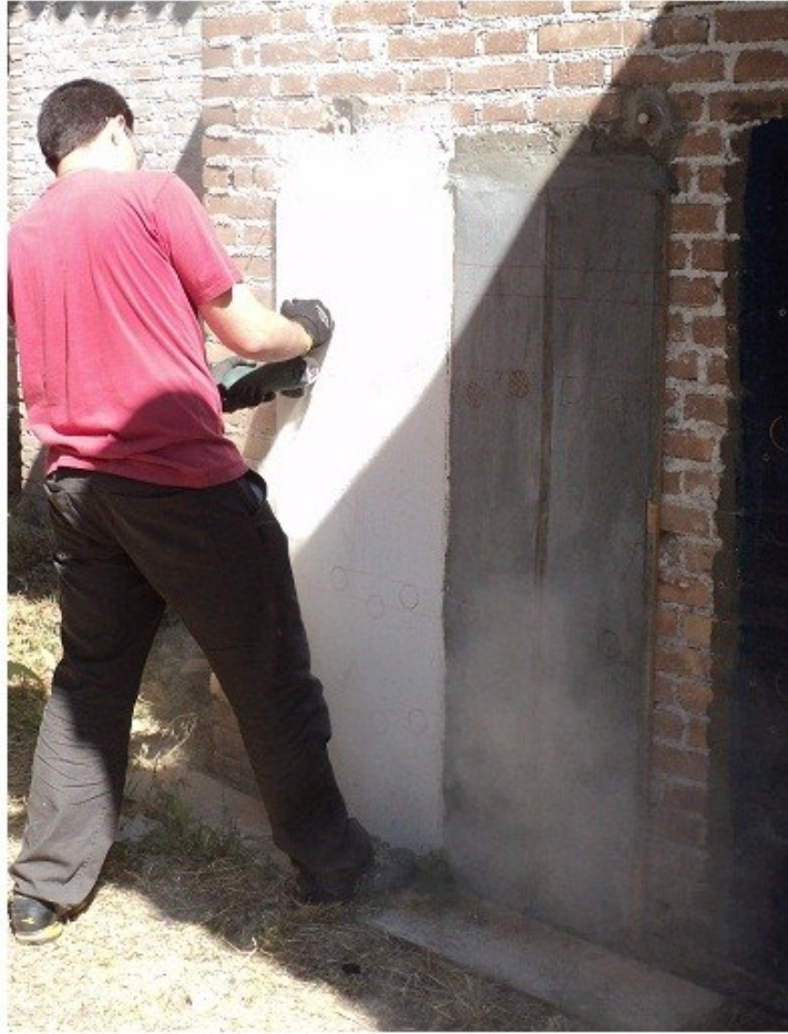
Figura 3.40: fase di incisione mediante smerigliatrice con disco diamantato su ALBARIA STRUTTURA applicato su supporto in mattoni.
