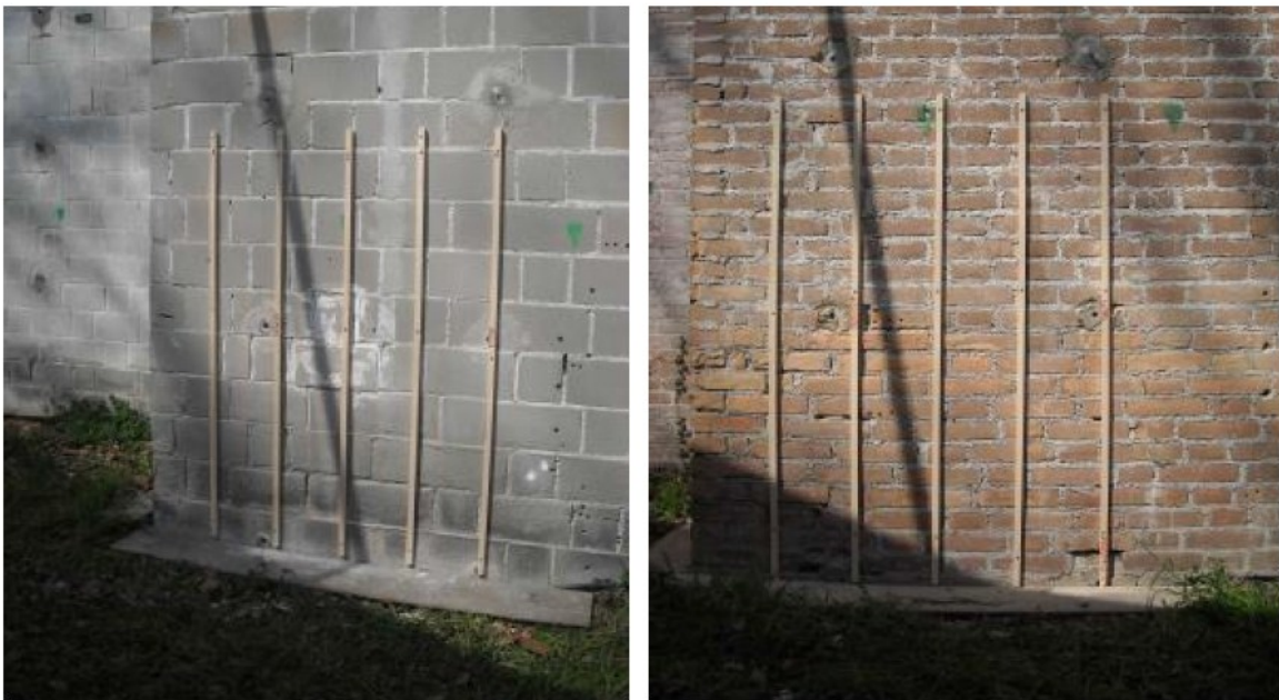
Figura 3.10: supporti per i compositi a matrice inorganica per il modello in pietra A4 e quello in mattoni B4.
