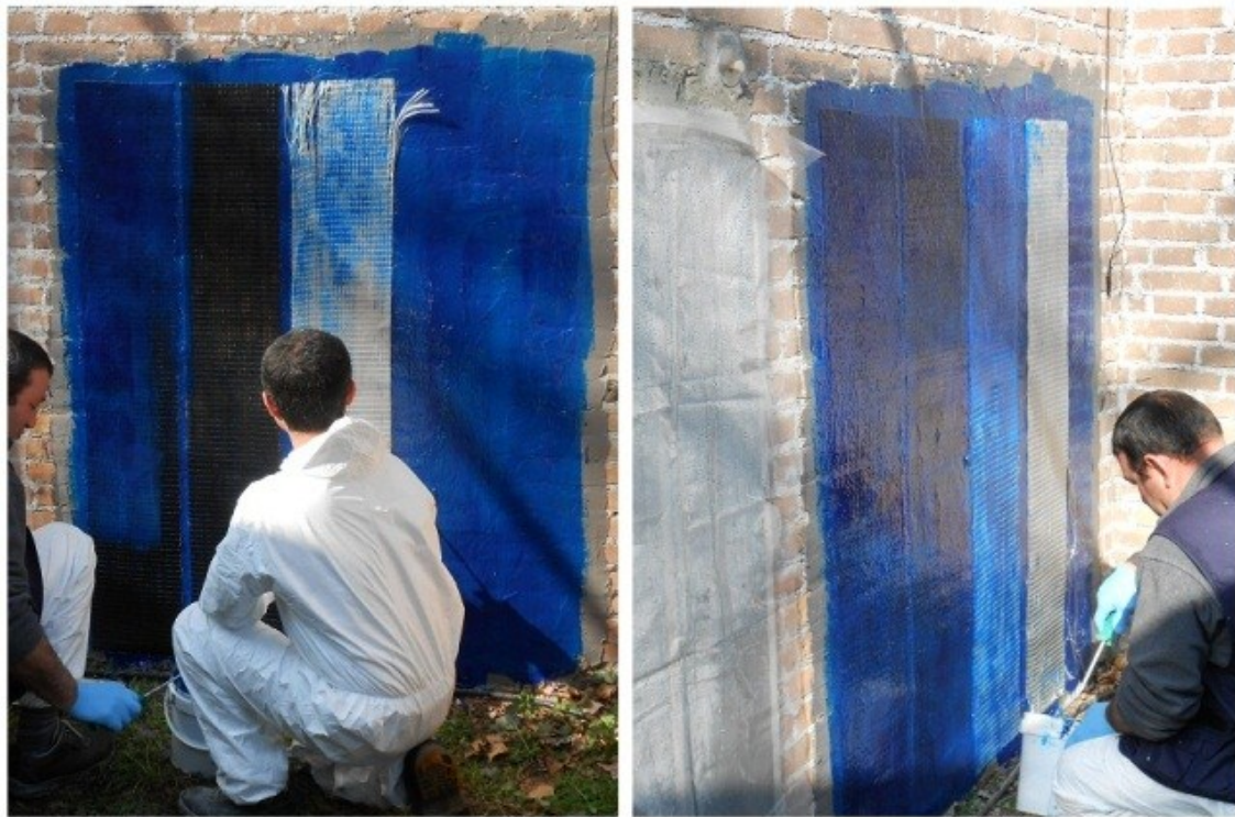
Figura 3.19: applicazione del composito a matrice epossidica MBrace Saturant Adesivo + MBrace Glass Fibres sul pannello B4 in mattoni.
