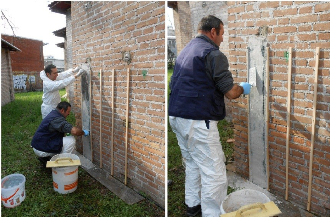
Figura 3.12: fasi di applicazione di ALBARIA STRUTTURA + MBrace Fibre Net CF 200B sul pannello B4 del modello in mattoni.
