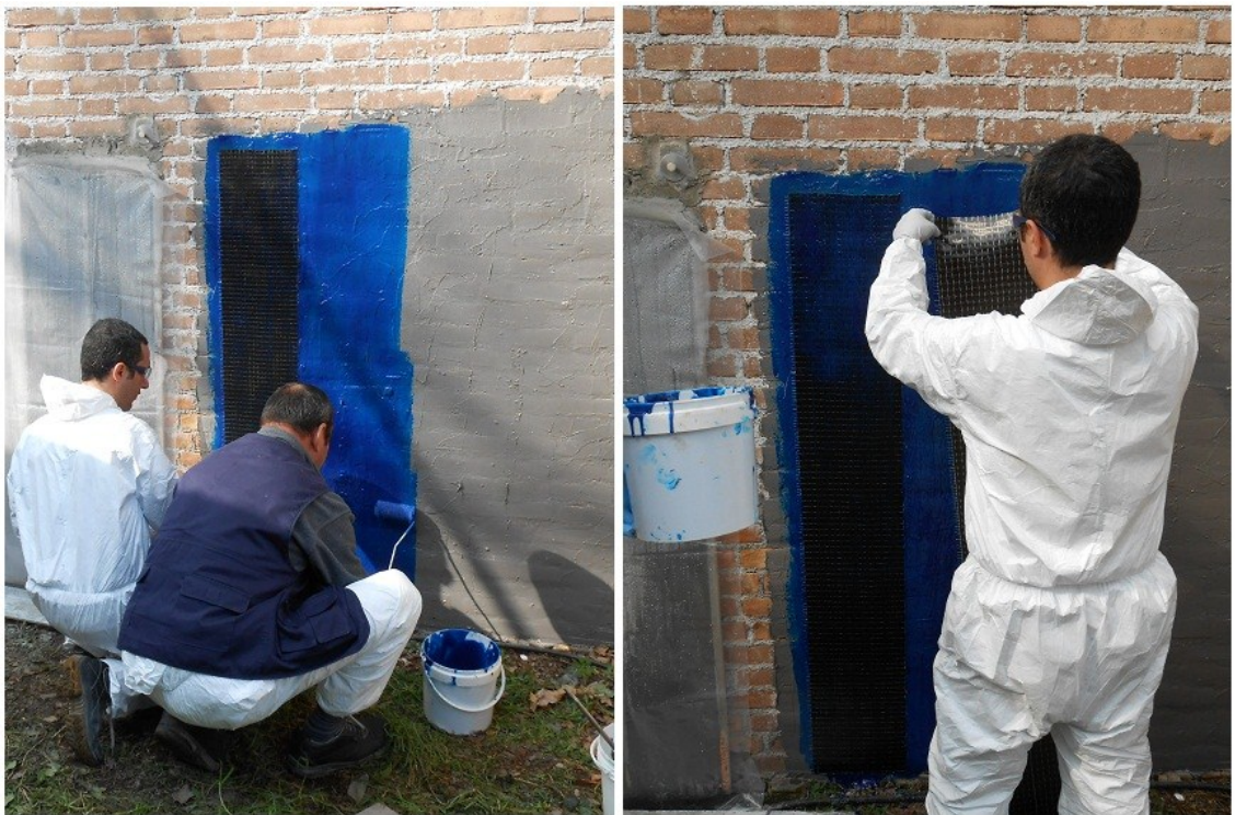
Figura 3.18: applicazione del composito a matrice epossidica MBrace Saturant Adesivo + MBrace High Strenght Carbon Fibres sul pannello B4 in mattoni.
