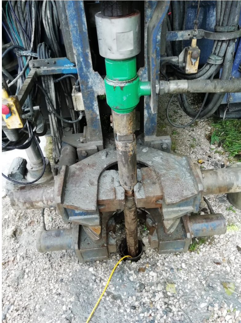
Figura 4.1 Strumento sperimentale in opera nel sito di Laghetti
