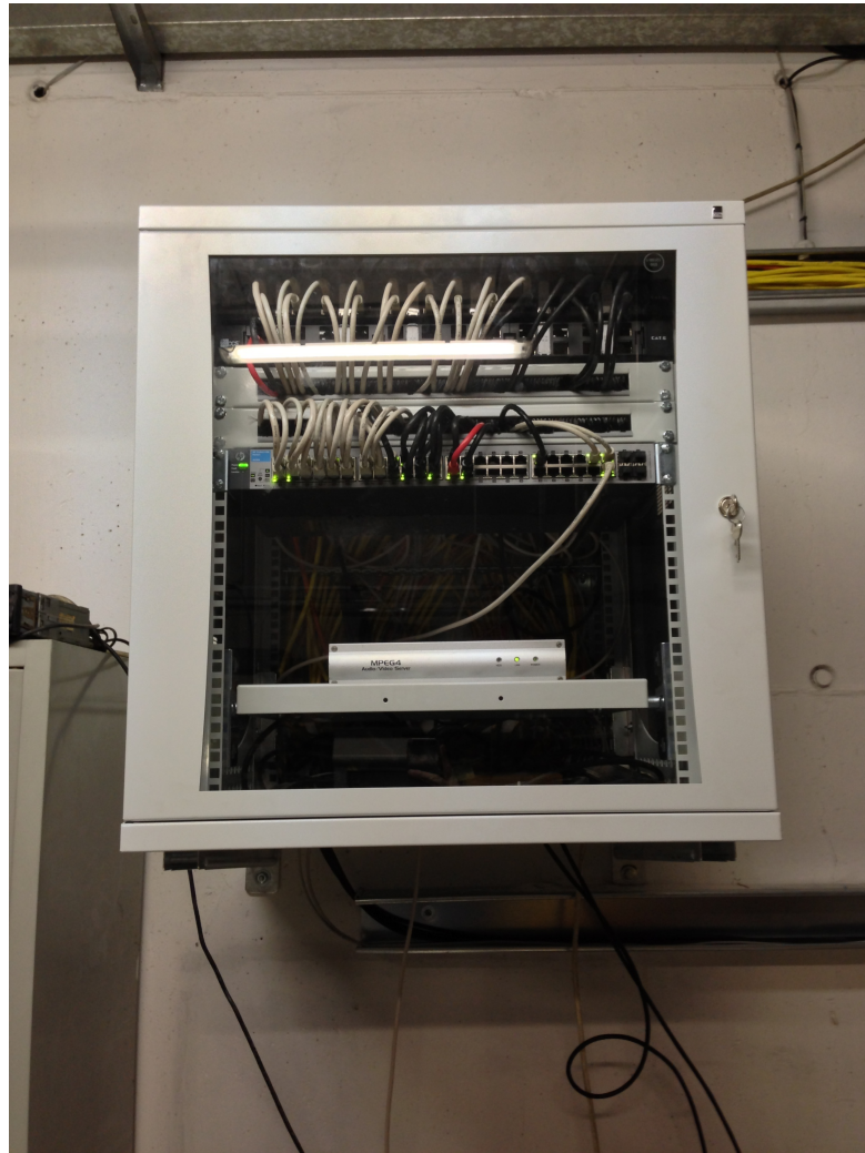
Figura 2.10: Quadro rack del nodo centrale della rete
