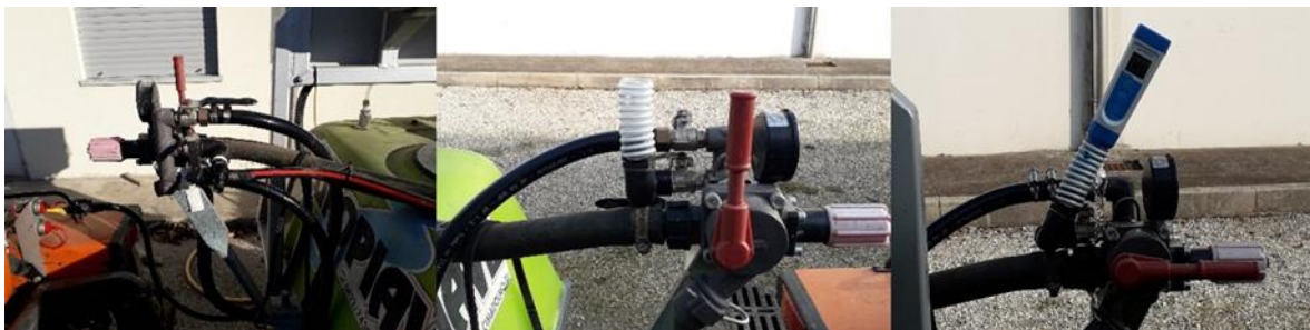
Figura 5.4. Gruppo di controllo e posizione misurazione ORP con strumento Apera
