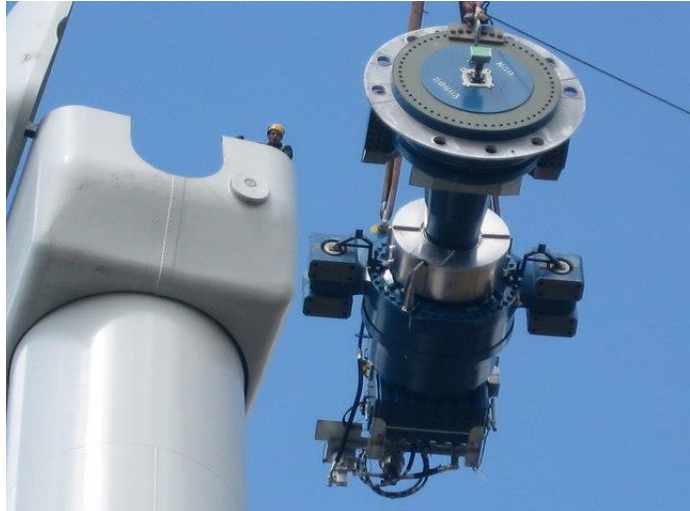
Figura 12: Componenti di una turbina eolica ad asse orizzontale (cambio, albero rotore e freno) vengono posizionati sulla gondola.
