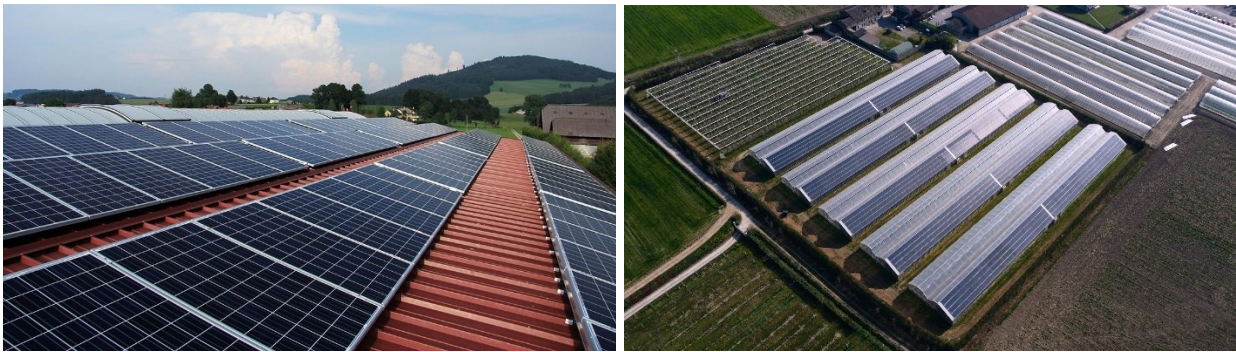
Figura 2.4: A sinistra un impianto fotovoltaico su tetto; a destra delle serre fotovoltaiche viste dall'alto.
