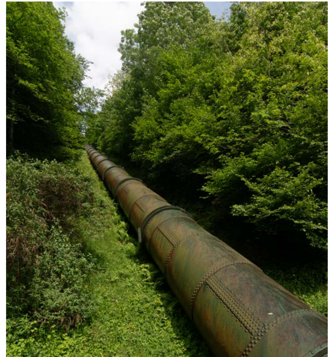
Condotta d'acqua per la centrale idroelettrica delle Moline, Sovramonte, 2024
