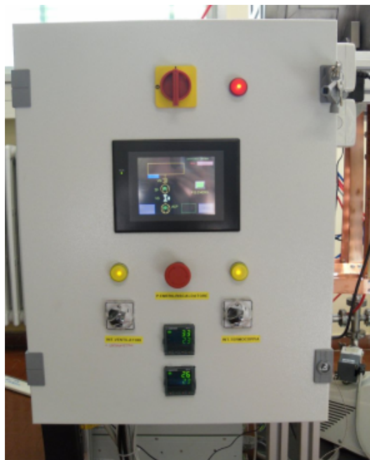
Figura 2-9: Termoregolatori per misurazione temperature, applicati nella parte bassa del box del quadro elettrico generale del forno di produzione
