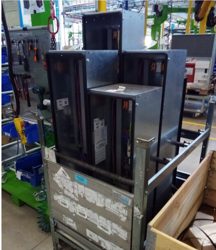
Figura 4.14: Esempio di sequenza di quadri elettrici
