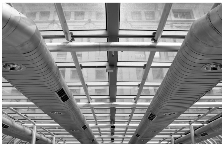
Figura 3.3 Condotte di aerazione
