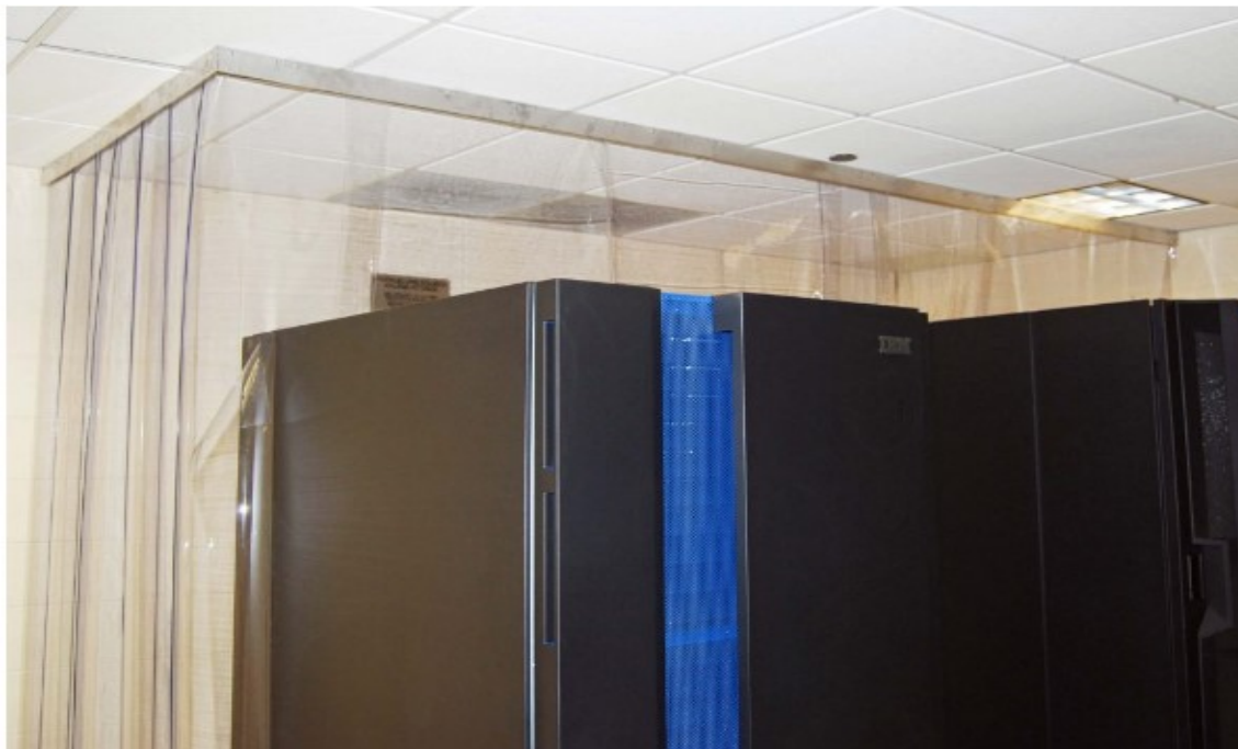
Figura 5.1 Esempio di tende flessibili nei rack
