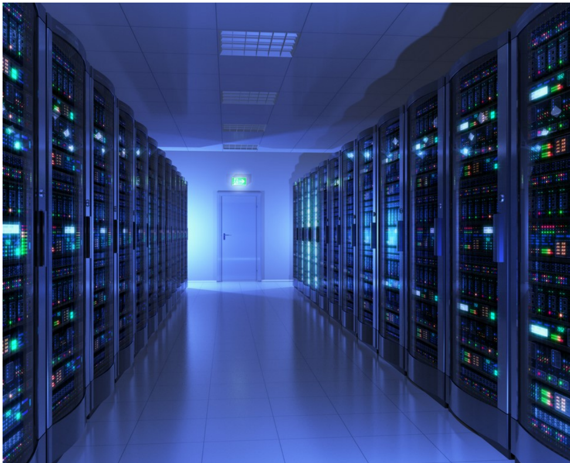
Figura 1.2 Tipica struttura interna di una sala server
