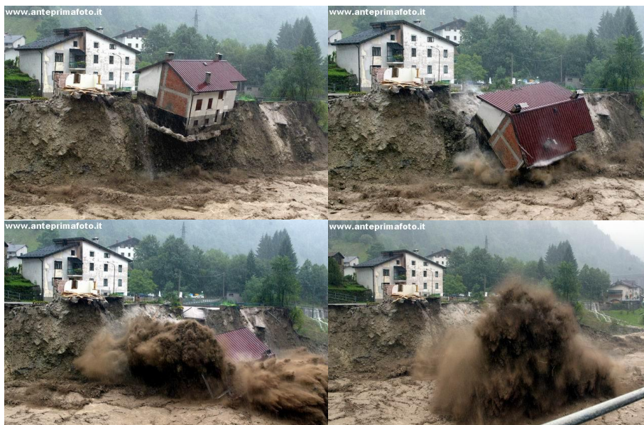
Fig. 7: l'erosione spondale dovuta all'alta capacità erosiva dei flussi di piena del Fella porta al cedimento di strutture e abitazioni presso Pietratagliata, alle quali viene a mancare il sostegno
