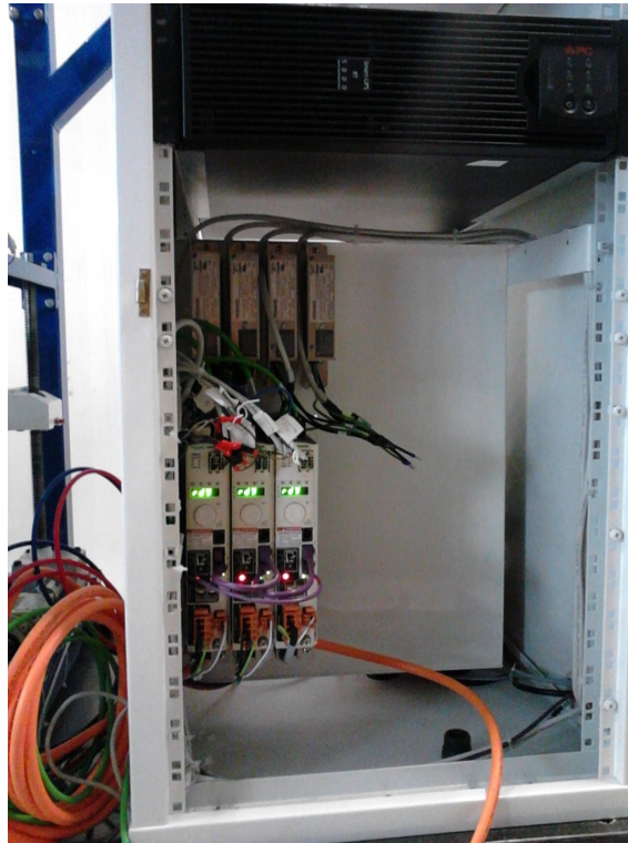
Fig. 2.28: Azionamenti collegati e attivati all'interno dell'armadio dei controlli
