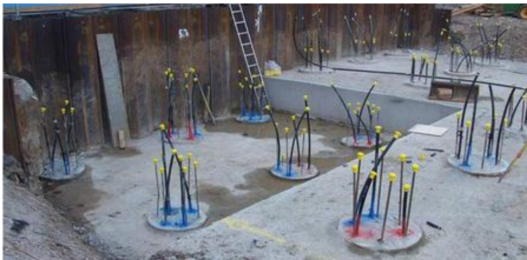
Fig.2.2.11: Sonde geotermiche immesse in pali di fondazione (www.luxuryinterior.it)
