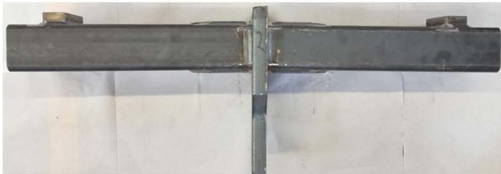
Vista laterale a rottura
