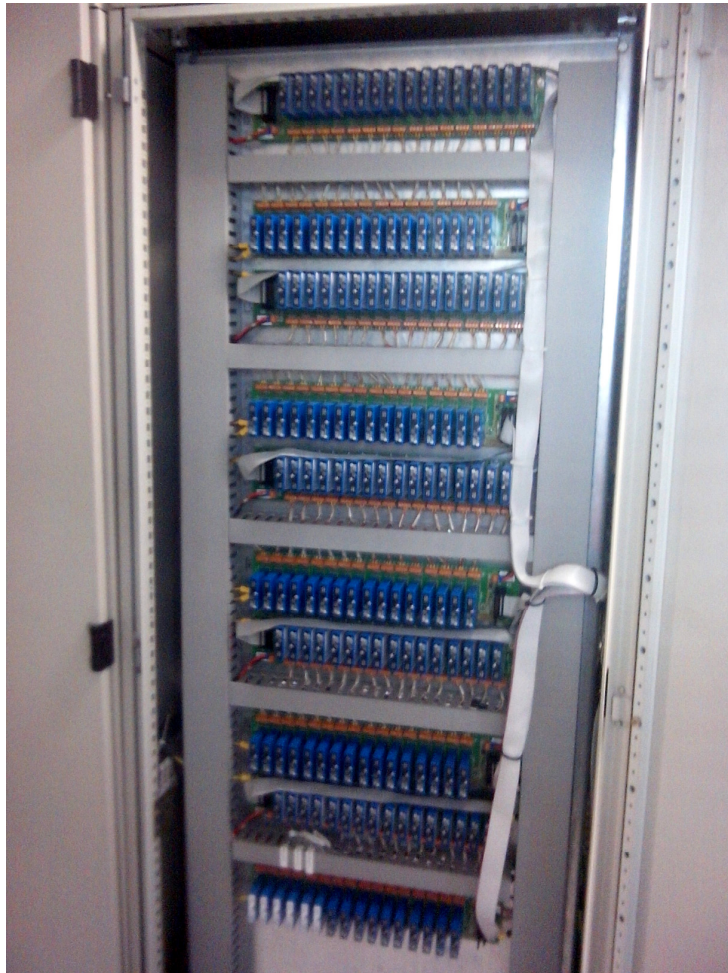
Figura 5 - Particolare del quadro elettrico che ospita i moduli di isolamento e trattamento dei segnali delle misure termiche di RFX.
